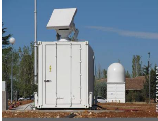
Figura 1.13: stazione radar vicino Madrid
