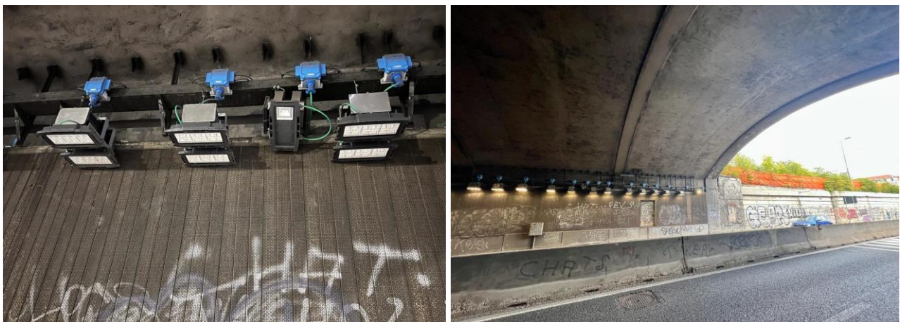
Figura 5-24 Dispositivi di illuminazione, derivatori, staffe passerella cavi, passerella cavi, porte e pannelli fonoassorbenti presenti lungo il sottopasso Lingotto.
