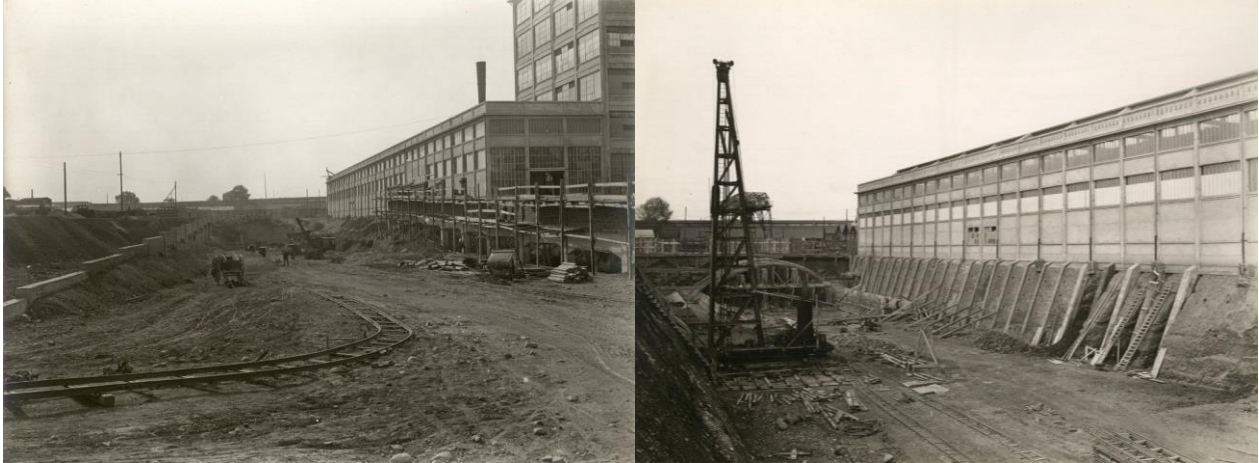
Figura 5-2 Sottopassaggio Lingotto, Via Nizza, Torino, vista del cantiere da est durante gli scavi, 1933, stampa alla gelatina bromuro d'argento. (Fonte www.fondazionetorinomusei.it , Mario Gabinio).
