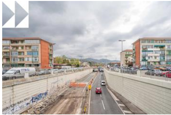
Figura 5-14 Lavori di rifacimento del piano stradale e sostituzione dei dispositivi di ritenuta [S17].
