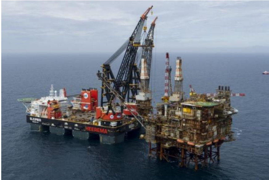
Figura 16: Decommissioning della piattaforma Brae Alpha tramite l'impiego di una nave gru semisommersibile, Mar del Nord [35].
