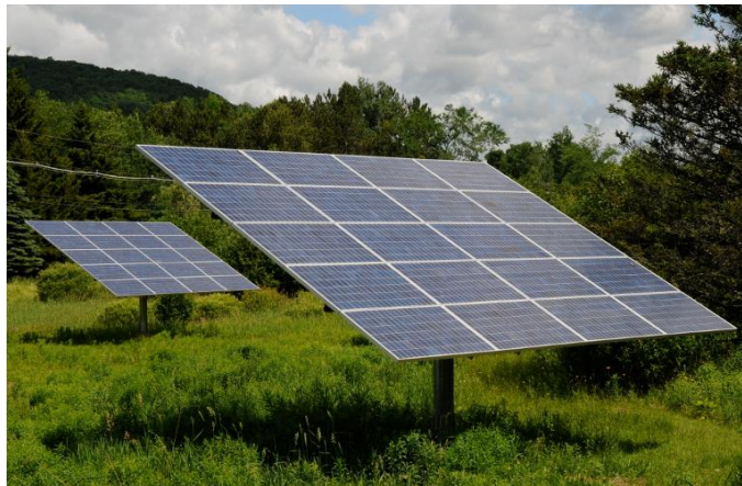
Figura 14: Impianto fotovoltaico con moduli montati su struttura con inseguitori solari ad asse doppio [8].
