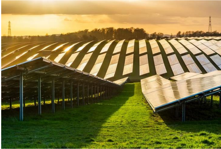
Figura 12: Impianto fotovoltaico con moduli montati su struttura fissa [7].
