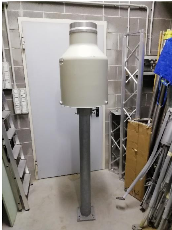
Figure 27 OTT Pluvio2, weighted rain gauge.
