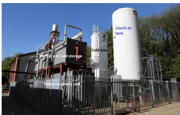
Figura 2.2. Primo impianto pilota LAES (350 kW/2.5 MWh) [3]
