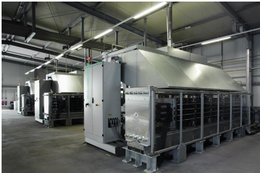
Figura 7. Sala di elettrolisi dell'acqua PEM dell'EnergiePark a Magonza, Germania [37]
