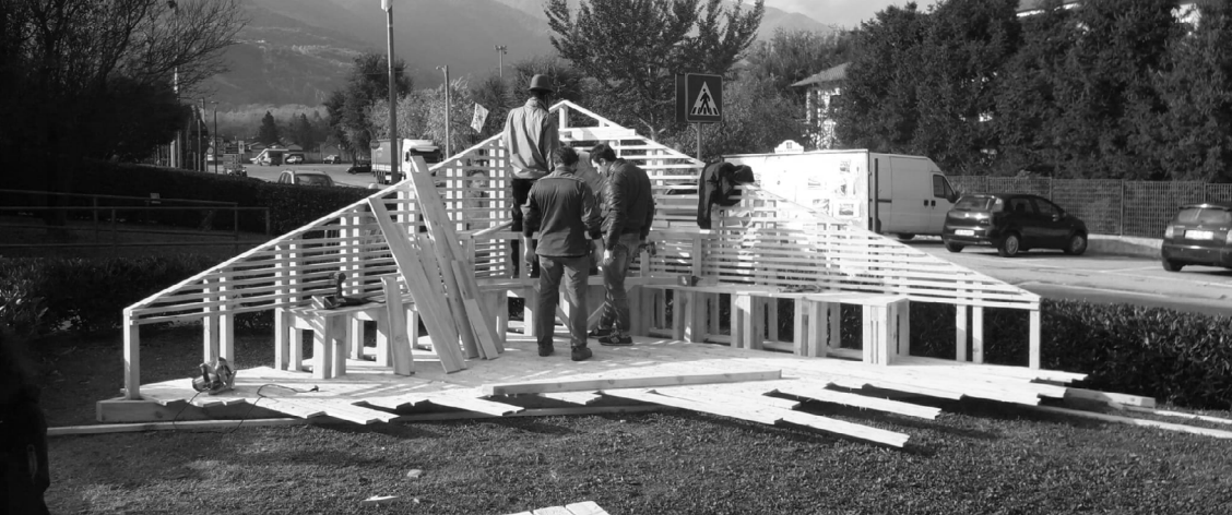
Fig. 60 La “grande panchina MATILDE” in fase di costruzione da parte dei ragazzi dell’Associazione Culturale Camposaz e da alcuni richiedenti asilo
