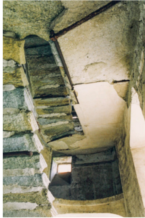
Figura 5 Reggia di Venaria Reale, scala detta "del Piacenza", 1788-89, stato precedente ai restauri. La griglia di barre in ferro che è stata rubata durante gli anni di abbandono della fabbrica sosteneva la rampa e ancorava la balaustra (da Burgassi, Novelli, Spila, p. 125).
