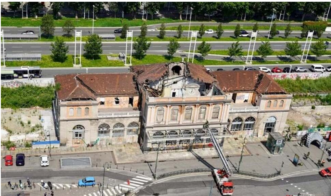
Figura 21: Il crollo del tetto nel 2023
