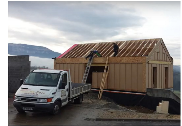
Fig.220. Struttura del piano primo e della copertura del progetto Blokiwood. Fonte videoclip: https://www.youtube.com/watch?v=F-QHASzeSUNk&ab_channel=Blokiwood
