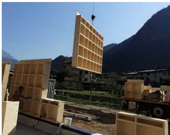
Fig.54. Travi e pilastri in legno lamellare con taglio a pettine per le connessioni a secco dei componenti del sistema Brix System . Fonte: https://u-build.org/projects/garden-studio/
