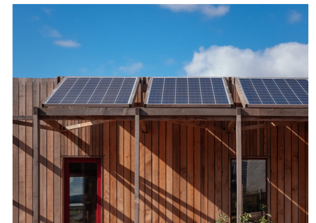
6. Pannelli solari usati come copertura della veranda
