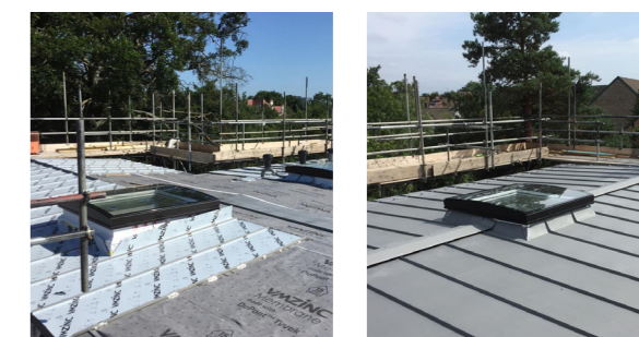
8. Seconda impermeabilizzazione e successivo completamento delle finiture del tetto tramite l'applicazione di pannelli zincati con giunture verticali
