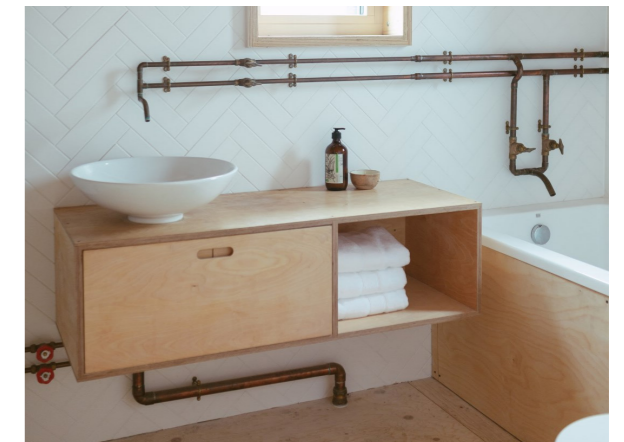
5. Sistema di impianto idrico a vista
