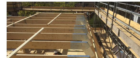
5. Installazione dei componenti strutturali speciale del tetto mansardato che fungerà da 3° piano
