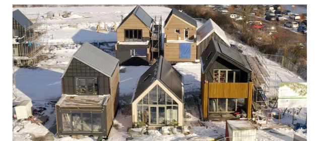
Fig.91. Abitazioni del progetto "De Stripmaker" costruite con il sistema Swift di WikiHouse. Fonte: https://www.wikihouse.cc/featured-projects/de-stripmaker
