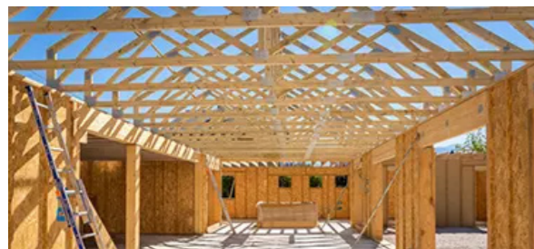
Fig.198. Telaio strutturale della copertura a traliccio per tetti a doppia falda dei progetti Blokiwood. Fonte: https://blokiwood.fr/nos-produits/toitures/
