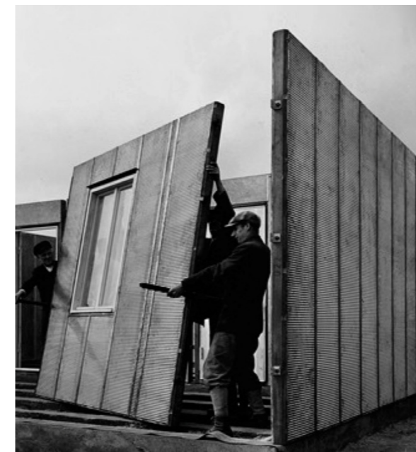
Fig.21. Movimentazione ed assemblaggio di un pannello parete costruito con il sistema Copper House. Fonte: Walter Gropius: Förster-Krafft-System House exhibited at "Das wachsende Haus" ("The Growing House") exhibition, Berlin, 1931-1932 . Wagner, p.67-68
