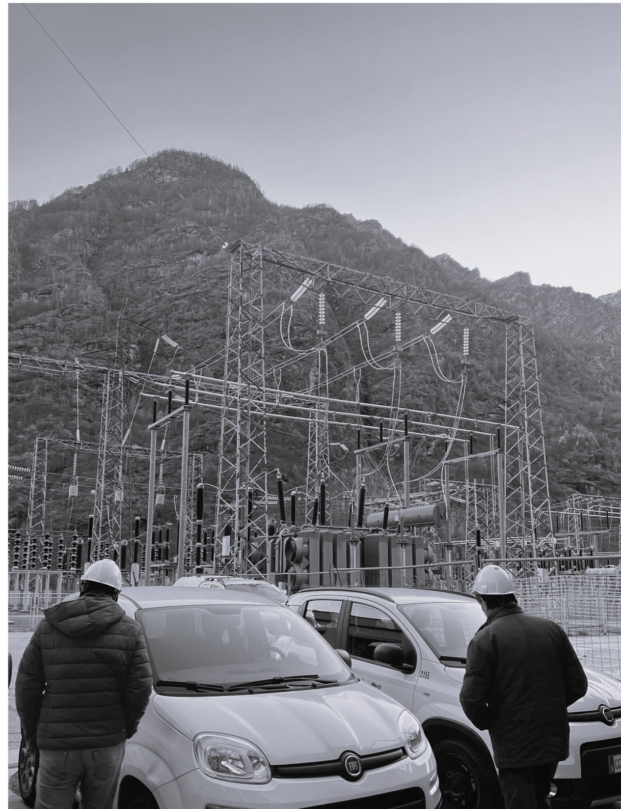
Impianto della Centrale idroelettrica di Rosone, Locana (TO). Autrici della fotografia: Celozzi, M. e Fiorino, L.
