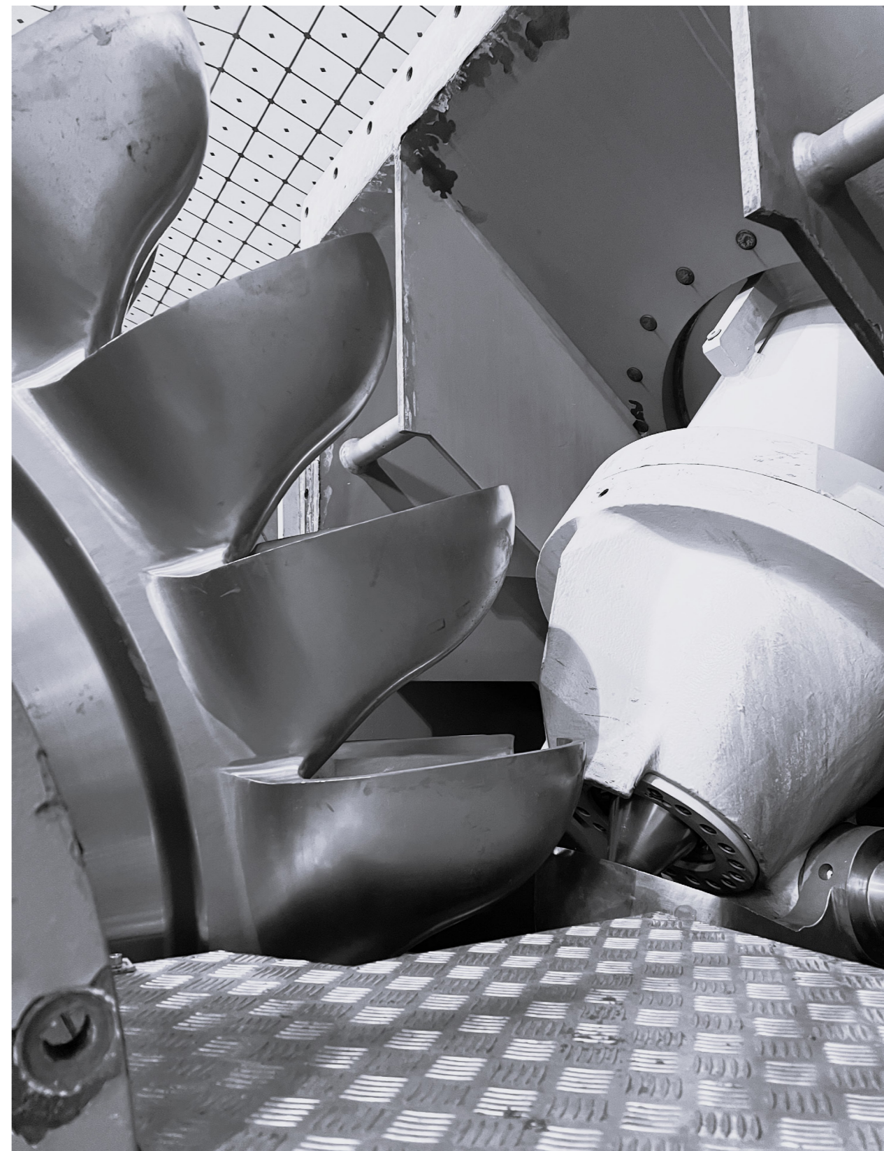
Turbine nella Centrale idroelettrica, Rosone, Locana (TO). Autrici della fotografia: Celozzi, M. e Fiorino, L.
