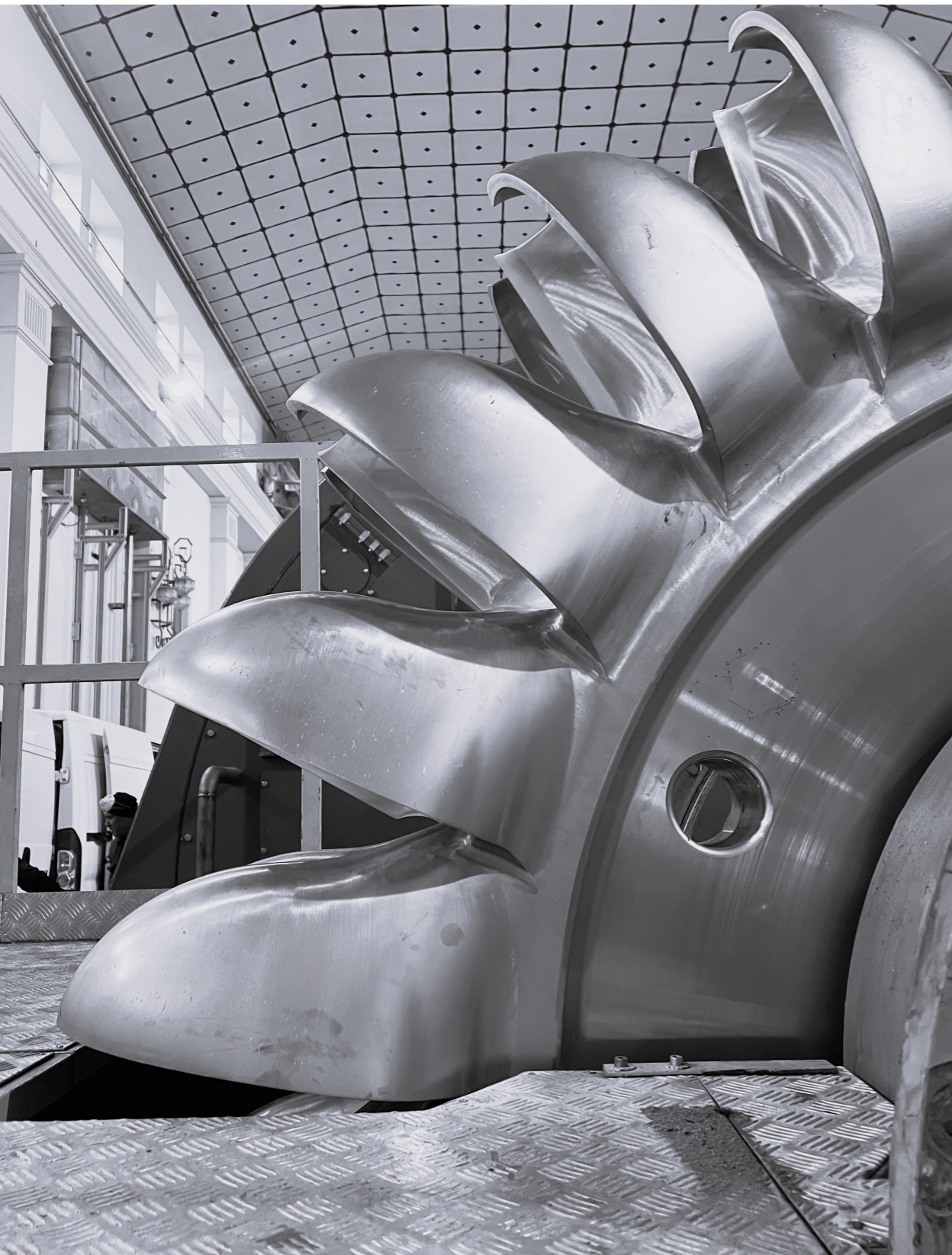
Turbine nella Centrale idroelettrica, Rosone, Locana (TO). Autrici della fotografia: Celozzi, M. e Fiorino, L.
