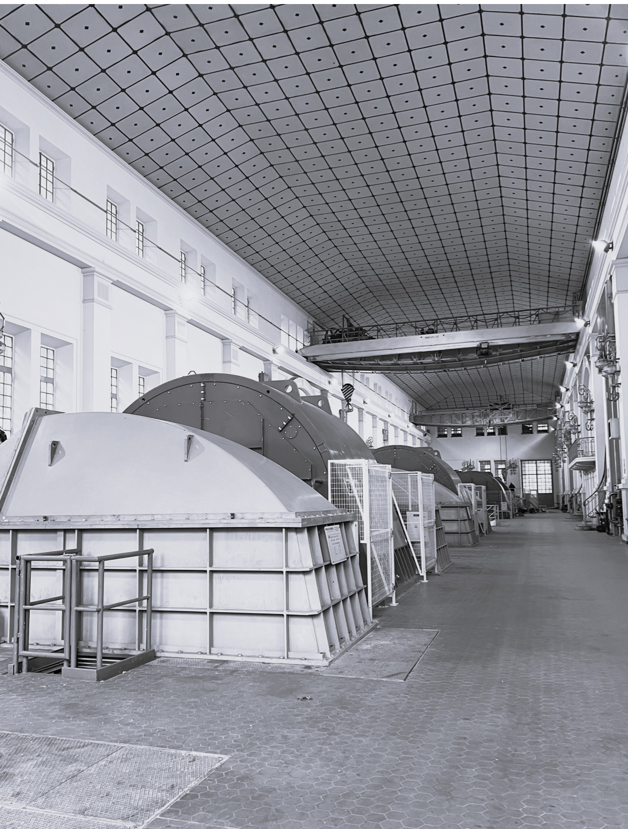
Interno della Centrale idroelettrica di Rosone, Locana (TO). Autrici della fotografia: Celozzi, M. e Fiorino, L.
