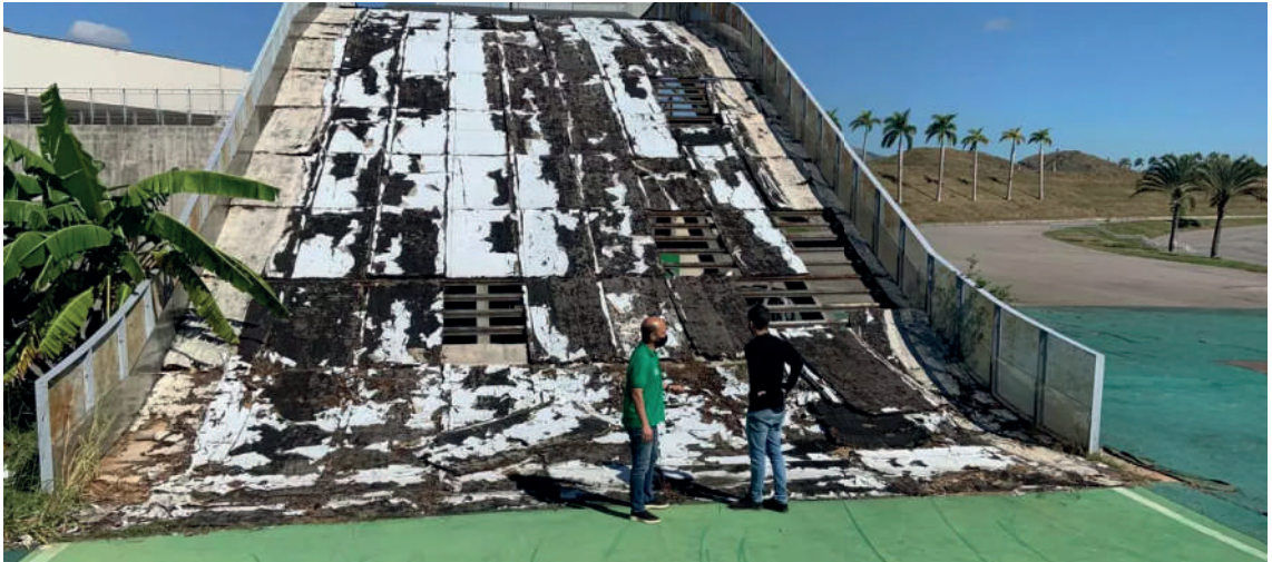
Fig. 101 Parque de Deodoro abandoned
