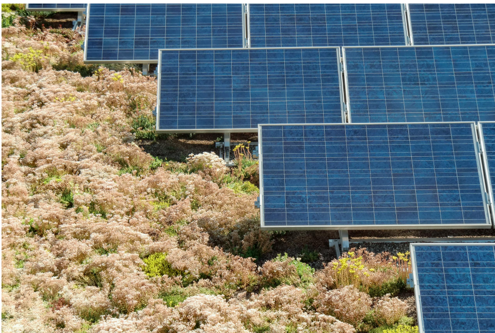
Fig 2.13 Impianto Fv su tetto verde, (climagruen.com)
