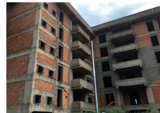
Fig.7 Incompiuta delle palazzine di via Trieste.
