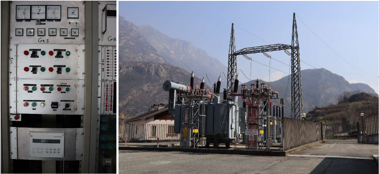
Figura 56: Quadro di controllo del gruppo 1 a sinistra e cabina di trasformazione all'aperto a destra, documenti dell'autore
