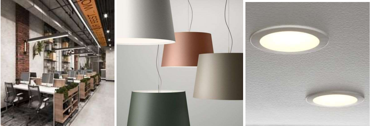
Figura 164: Illuminazione inserita al secondo piano all'interno degli uffici, www.pinterest.it
