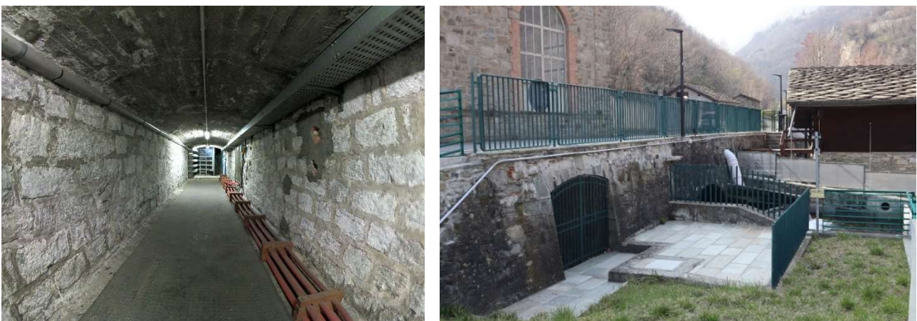
Figura 53: Galleria di passaggio dei cavi a sinistra e ingresso alla medesima galleria a destra, documenti dell'autore
