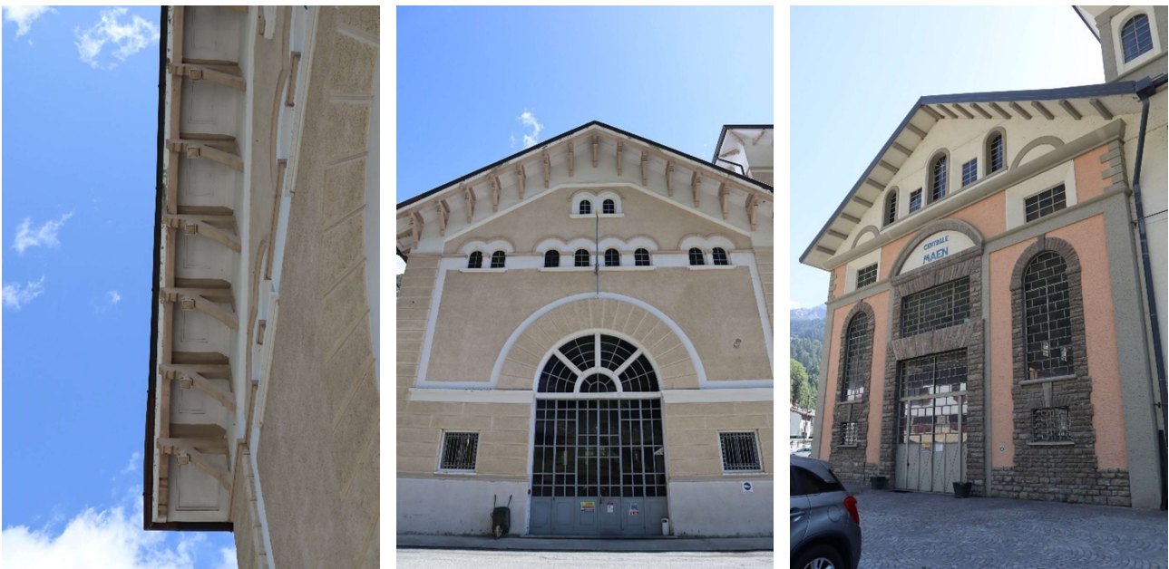
Figura 33: Travi del tetto di Covalou, centrale di Covalou, centrale di Maën, documenti dell'autore
