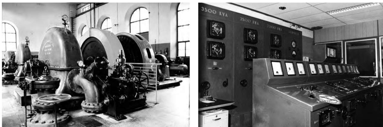
Figura 41: Gruppi e sala di controllo originali, Storie d'acqua e d'energia - CVA
