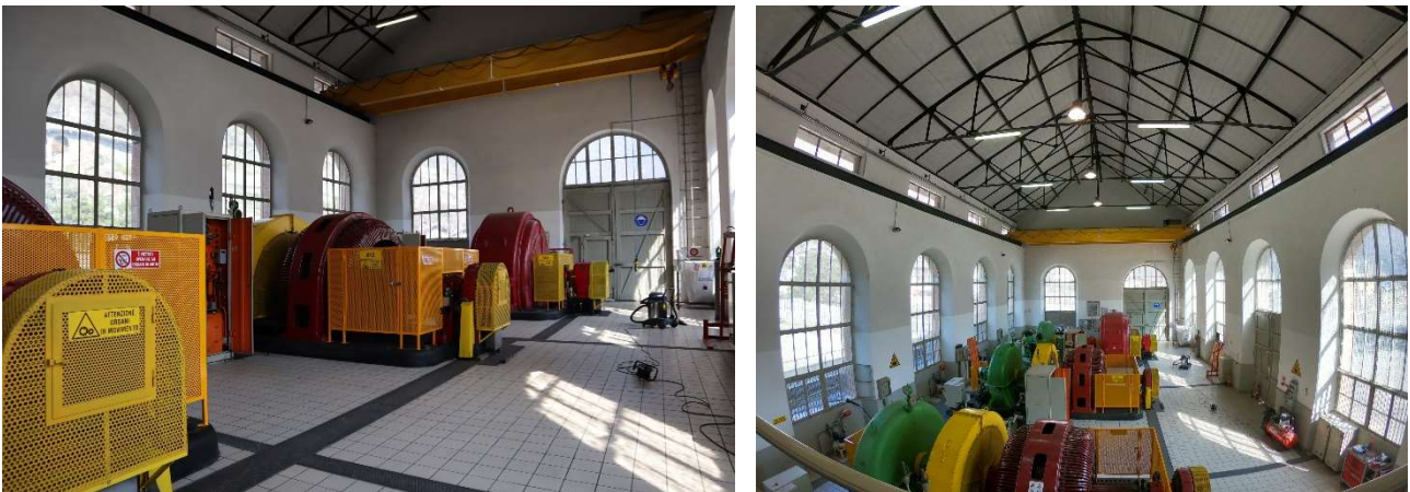
Figura 57: Interno della centrale idroelettrica, documenti dell'autore
