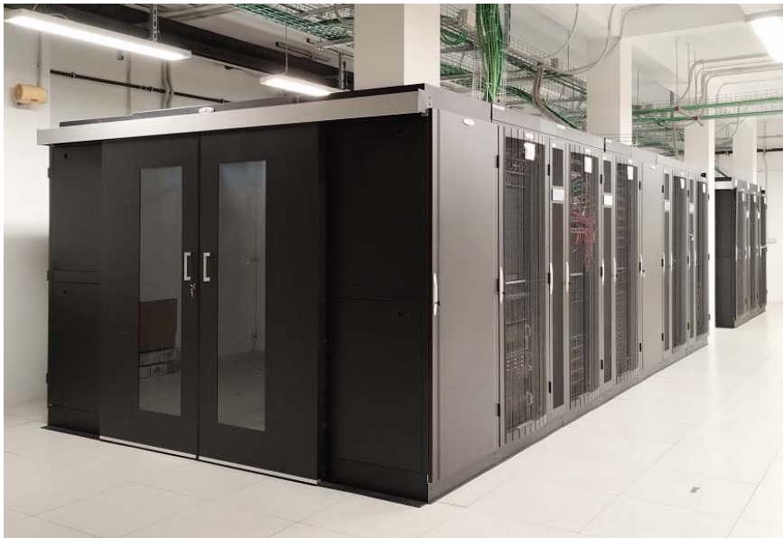
Figura 41. OpenStack Polito: isola rack dedicata nel data center.
