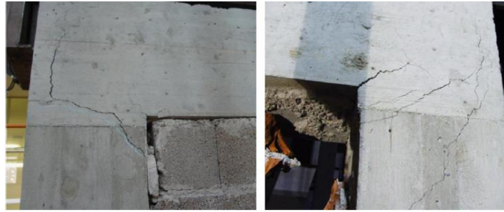
Figura 2.8 – Danneggiamento della colonna e del nodo nel provino S1B [32]
