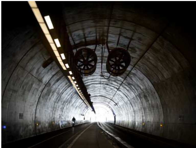
Fig. 4.15 Ventilatori in galleria
