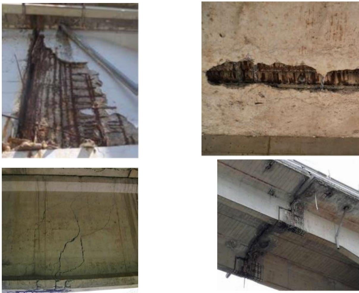
Figure 2.5-2.8: rispettivamente armatura scoperta ed ossidata, guaine in vista, lesioni trasversali e difetti su selle Gerber (ricavate da [4])
