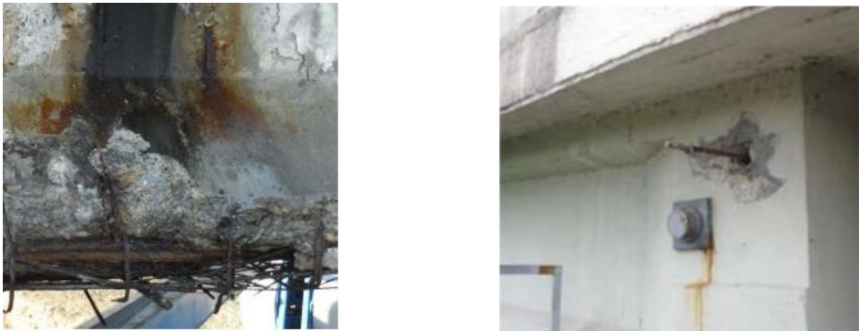
Figure 2.3 e 2.4: rispettivamente riduzione di armatura da precompressione e fuoriuscita delle barre d'ancoraggio (ricavate da [4])
