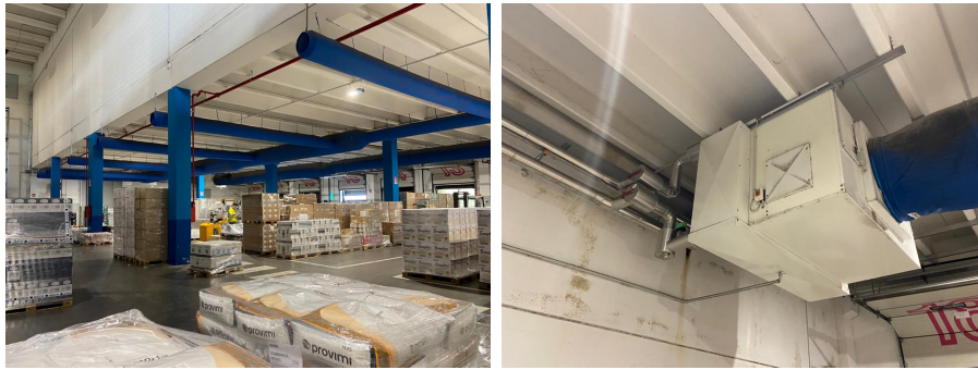
Figura 4.6: Condotti e scambiatori di condizionamento nel magazzino 2
