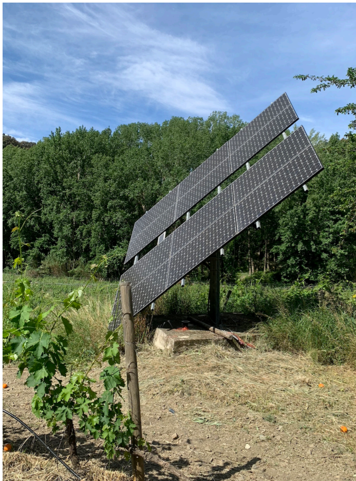
Figura 93 - Pannelli solari presenti nella vinicola
