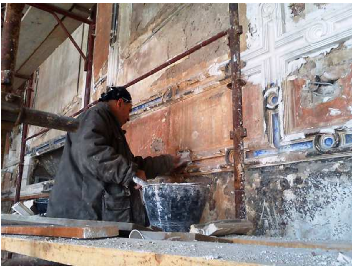
Ricostruzione delle parti mancanti della decorazione in gesso nella biblioteca di “Vijecnica” a Sarajevo
