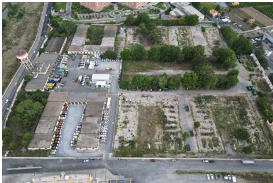
Fig. 44 Albenga. Ex caserma Aldo Turinetto- Stato delle demolizioni, a sinistra i due edifici mantenuti. 2023
