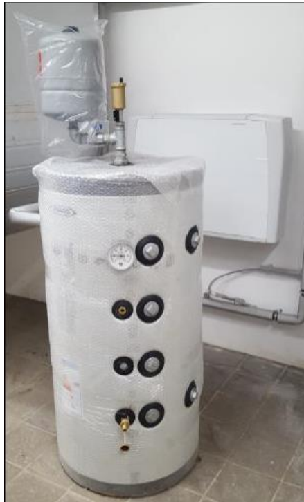
Figura 31 Vaso di espansione (in alto) e serbatoio di accumulo (in basso) presenti in impianto
