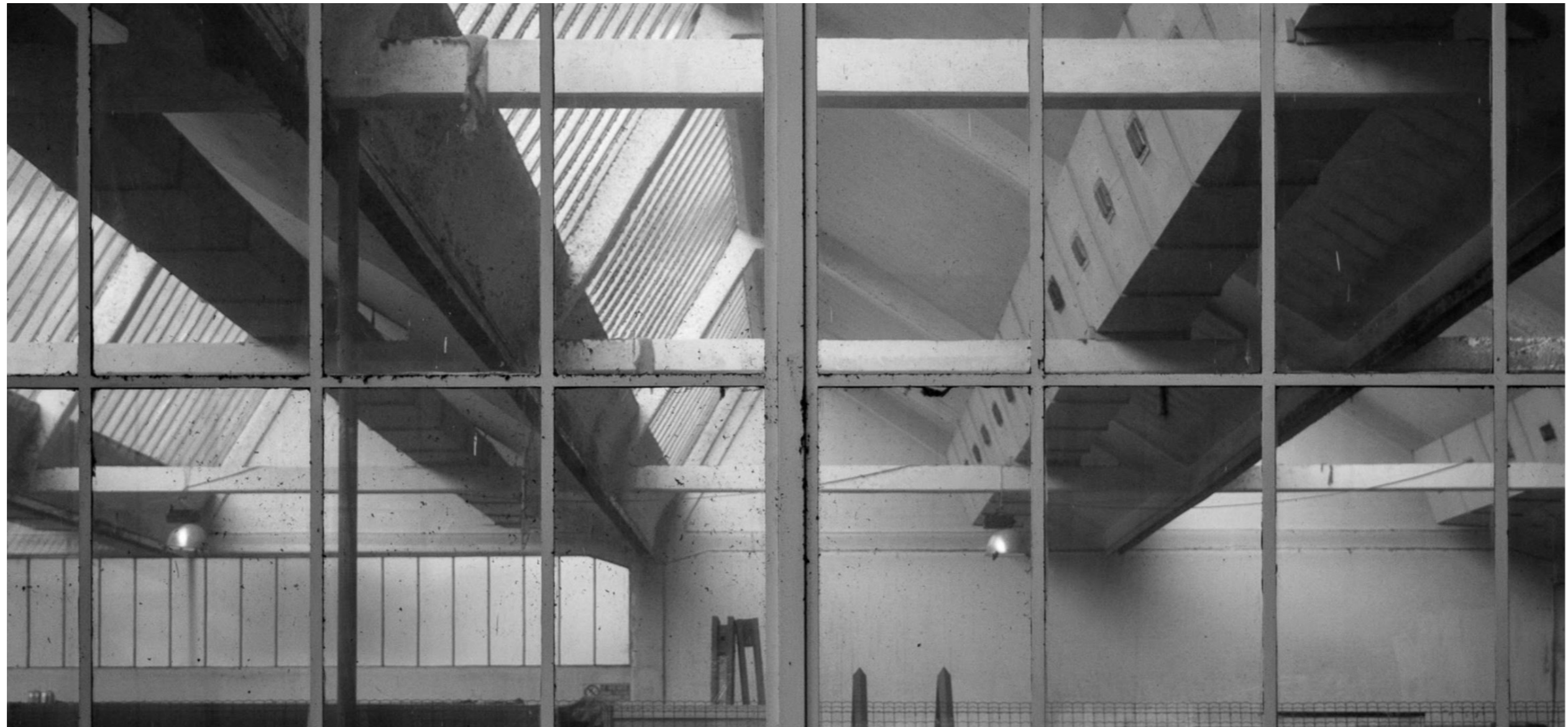
Foto scattata da Giulio Marzullo durante un sopralluogo all'interno del complesso industriale, tratta dall'archivio Nextabasso
