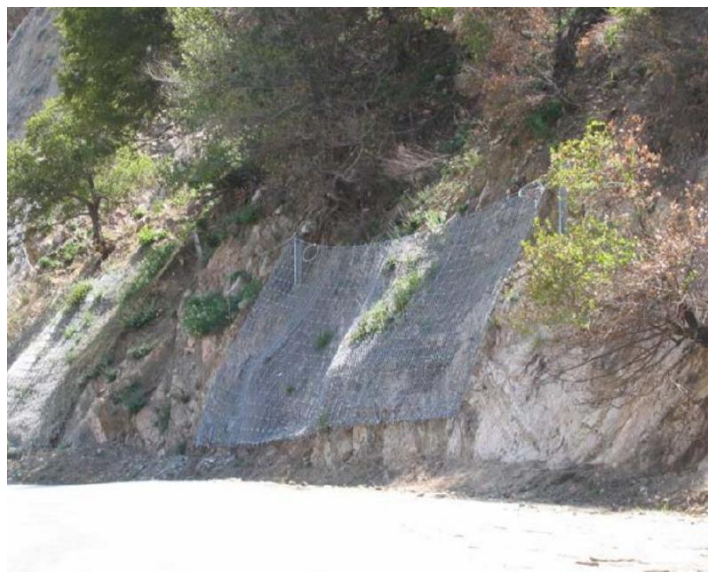
Figura 25 Esempio di posizionamento di una rete ibrida paramassi nella zona terminale del pendio (10)
