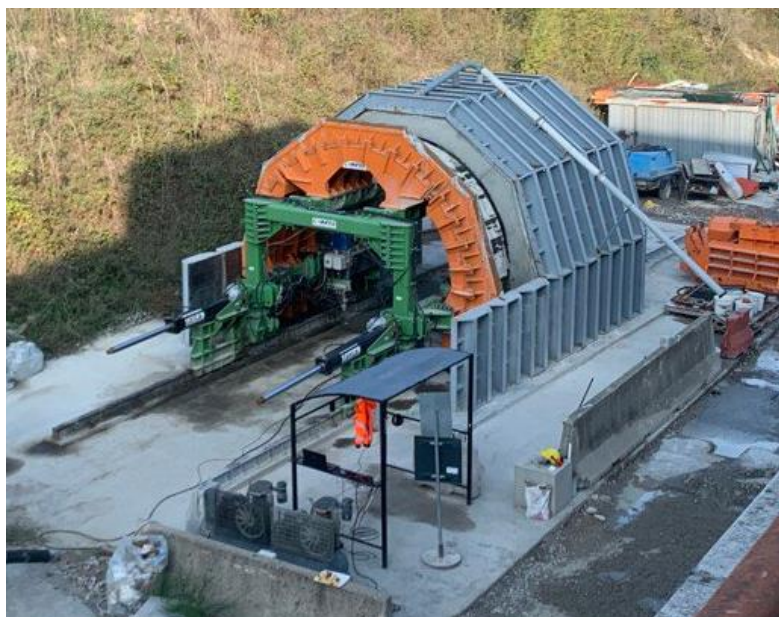
Figura 3-7: Impianto in scala reale.
