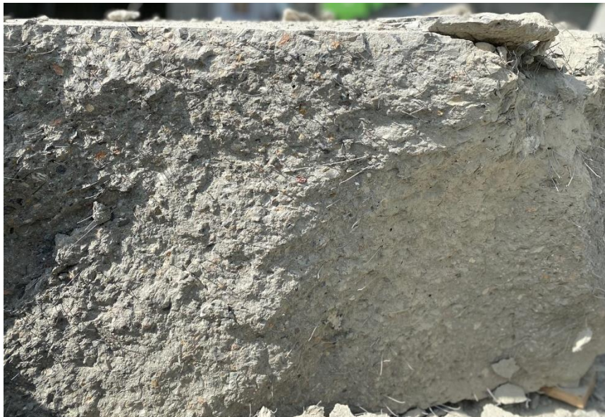
Figura 5-9: Distribuzione delle fibre in conci demoliti.
