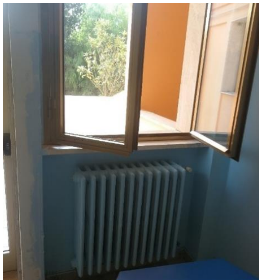
Figura 39 – Foto rappresentativa dei corpi scaldanti costituenti il sottosistema di emissione
