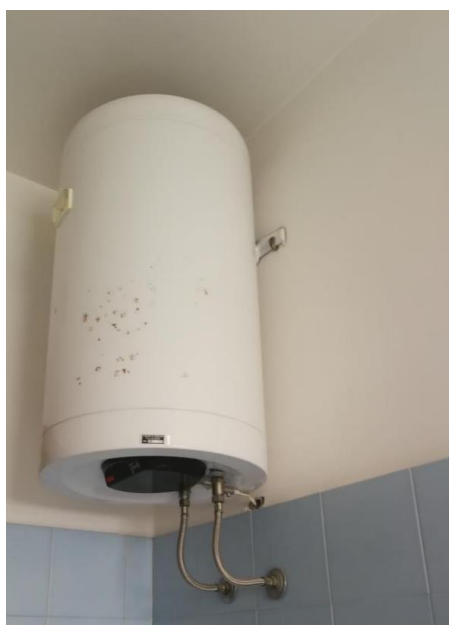
Figura 40 – Foto rappresentativa dei boiler elettrici installati
