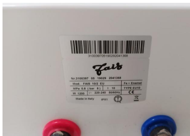
Figura 41 – Targa dei boiler installati
