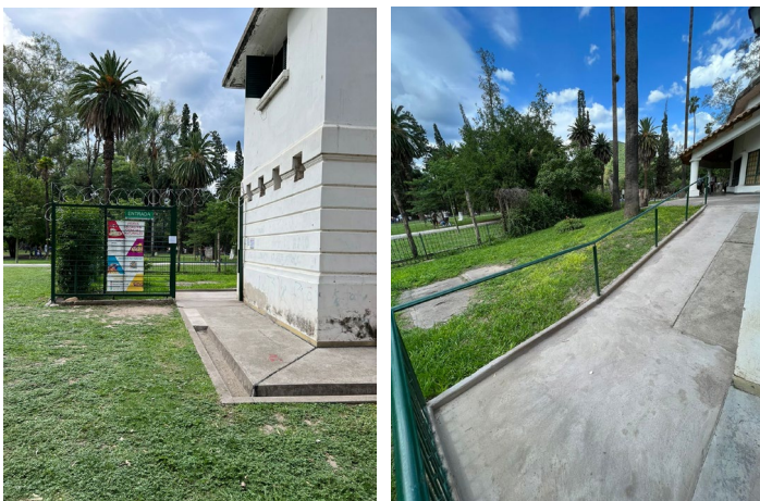
Ingresso attuale con rampa senza pendenza adeguata, fermapièdi inferiore a 10 cm e senza corrimano doppio.
