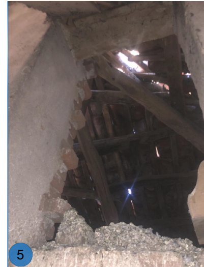
Foto 5: Apertura di un foro in copertura per spostamento e caduta di coppi
