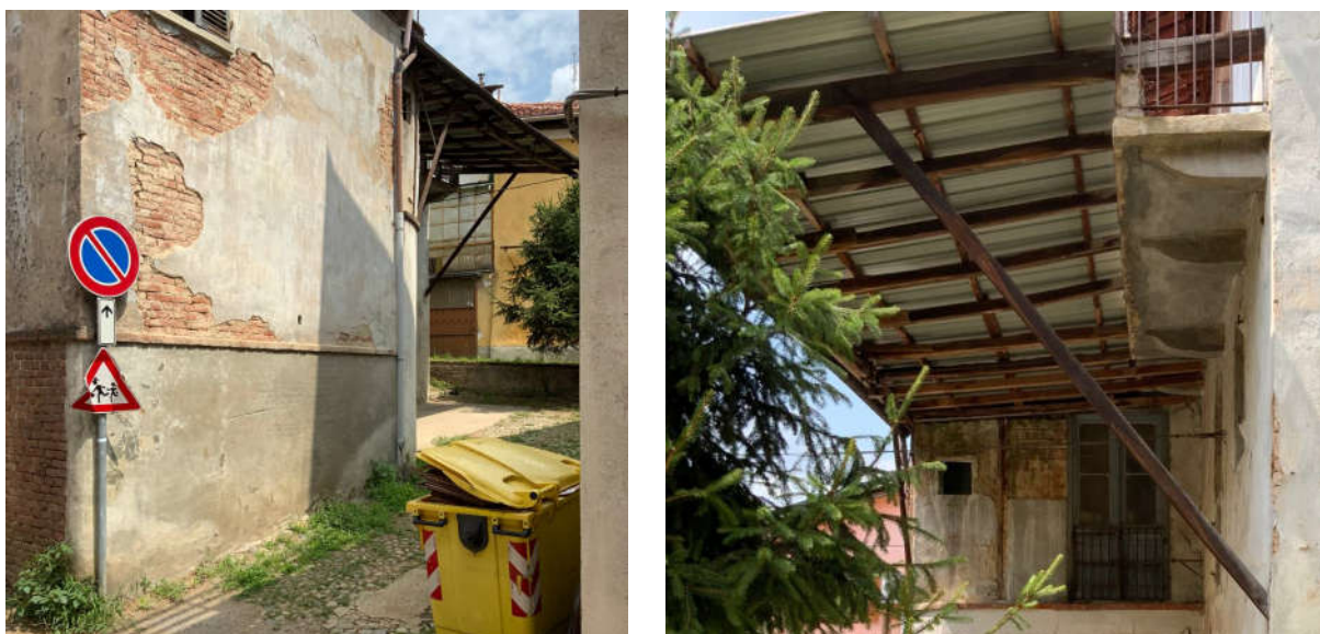
Figura 13: Da sinistra, distacco di intonaco sul fronte sud che interessa le pareti perimetrali; dettaglio della copertura in lamiera da rimuovere nell'intervento di restauro.
