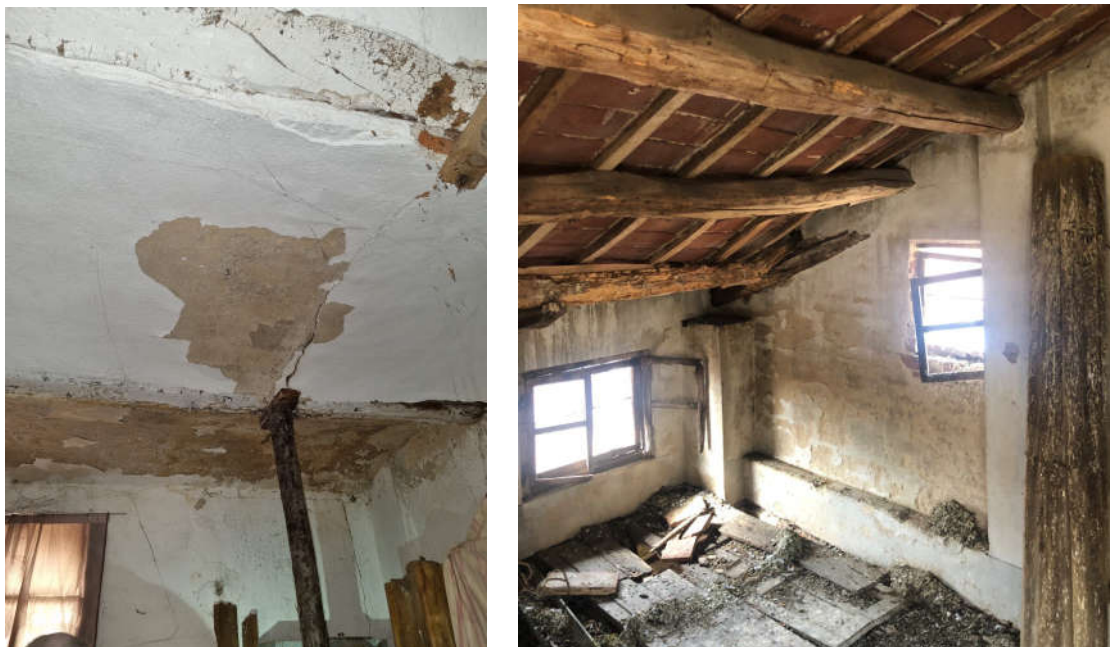
Figura 16: Da sinistra, locale ex stalla con solaio in voltini crepato; degrado degli infissi esistenti nel locale sul terrazzo. (Fonte: foto dell'autore)
