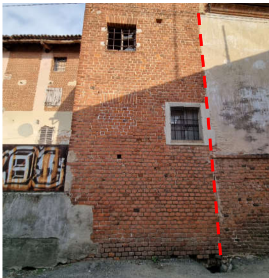
Figura 20: Prospetto Ovest su via Perla. La linea rossa tratteggiata evidenzia la mancanza di ammorsature tra le pareti, che suggerisce una diversa epoca di costruzione dei due volumi verticali.
