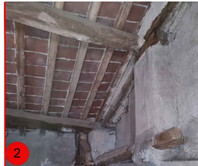
Foto 2: Elemento spezzato di capriata inglobato in un getto di consolidamento (lato Est).
