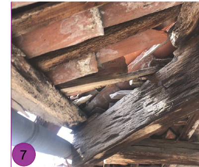
Foto 7: Ammaloramento del cantonale per azione di agenti fitopatogeni e distacco di elementi di orditura secondaria e coppi di copertura.
