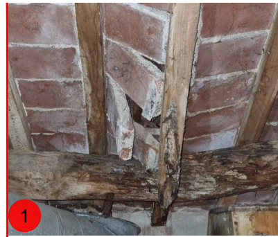
Foto 1: Listello in legno rotto con arcareccio inflesso e conseguente distacco di elementi di copertura (tavelle).
