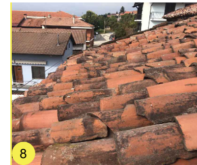
Foto 8: Esterno copertura locale al terzo piano. Si osserva la condizione di degrado dei coppi.
