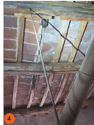
Foto 4: Rotazione fuori piano delle tavelle per inflessione dell'arcareccio (orditura primaria) e marcescenza del listello trasversale (orditura secondaria).
