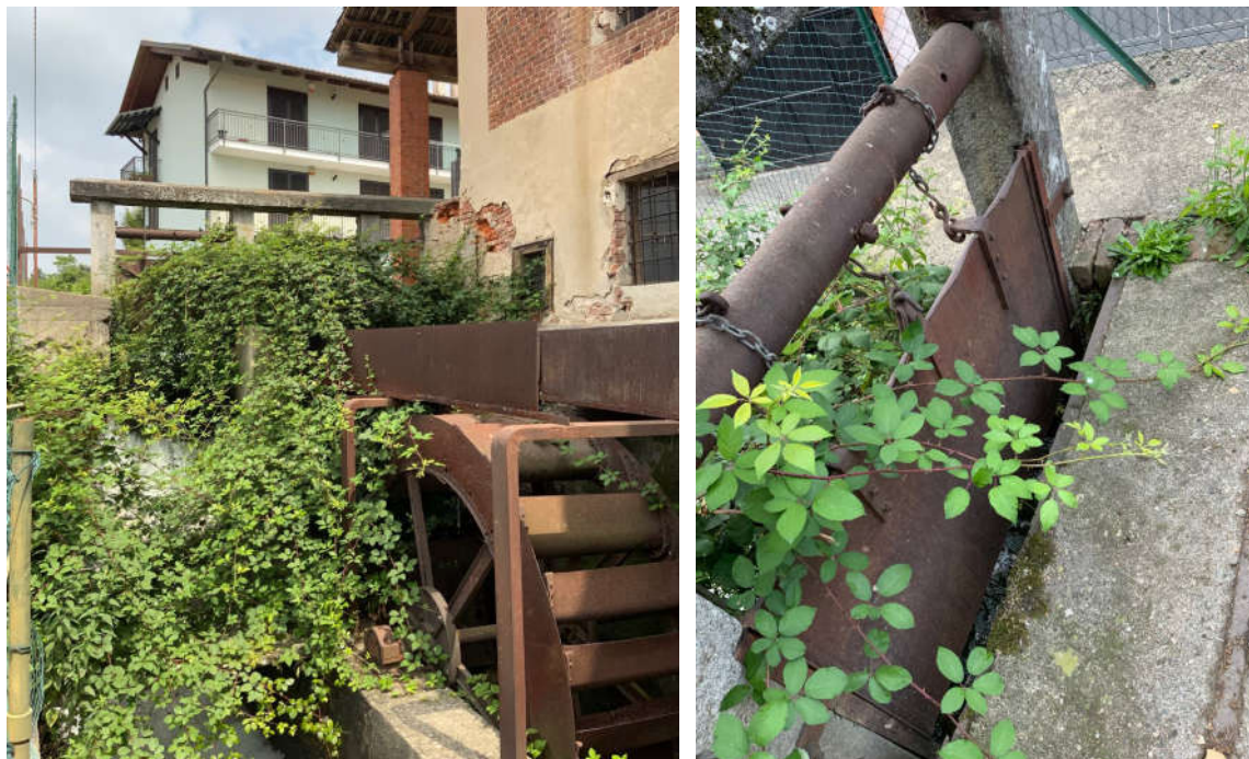
Figura 15: Gora del mulino e vegetazione infestante sul fronte Ovest; girante, canaletta e paratia in avanzato stato di ossidazione. (Fonte: foto dell'autore)
