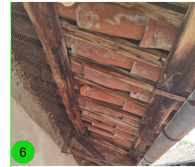
Foto 6: Listello in legno ammalorato di fissaggio della linea di gronda.
