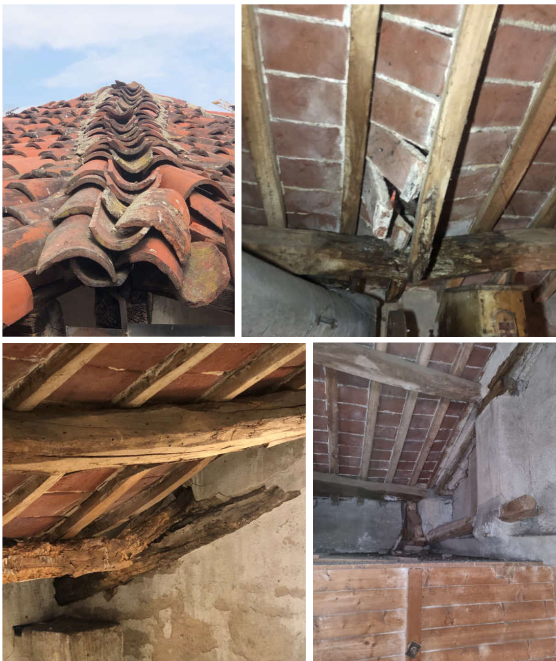
Figura 17: Dall'alto a sinistra, dislocazione di coppi di copertura; ammaloramento tralici lignei copertura; rottura arcareccio per agenti fitopatogeni; errata esecuzione di consolidamento in getto di calcestruzzo di capriata lignea tranciata.
