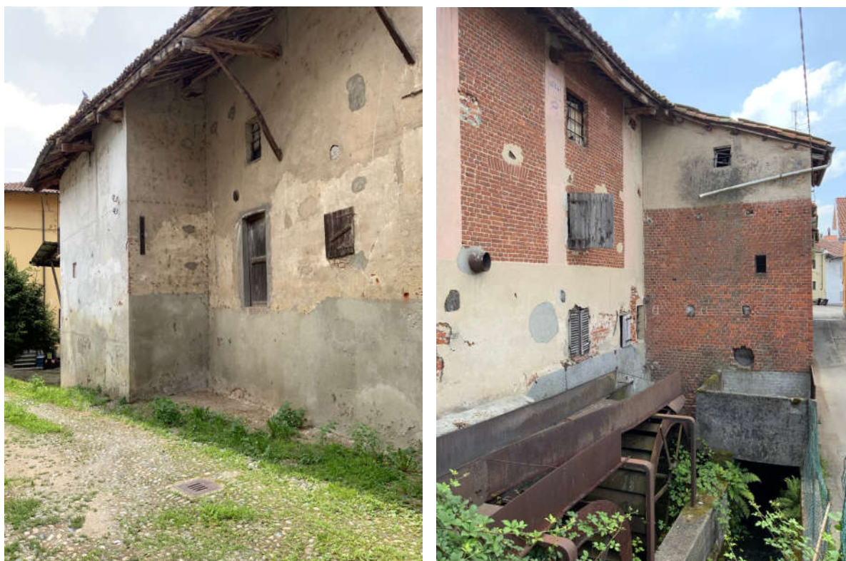
Figura 18: Da sinistra, vista fronte Est con rabberciatura delle pareti perimetrali esterne e fenomeni di umidità di risalita; fronte Ovest con vari fenomeni di degrado diffusi sulle murature.
