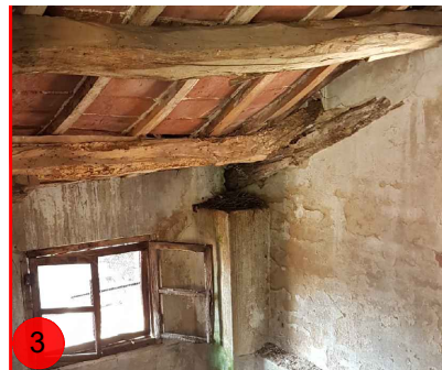
Foto 3: Interno copertura locale al terzo piano. Rottura arcareccio per degrado da agenti fitopatogeni.
