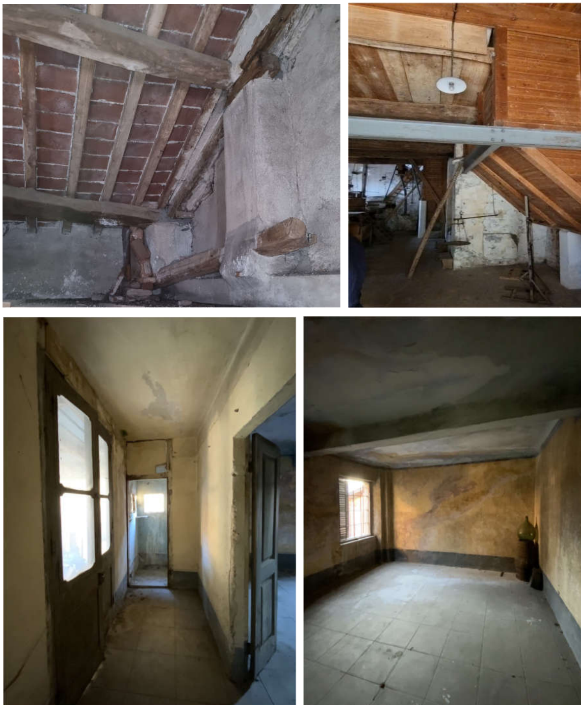
Figura 23: Dall'alto in senso orario, intervento di probabile consolidamento in getto di consolidamento di una capriata tranciata; trave IPE di probabile recente installazione in funzione di un intervento di consolidamento effettuato sulla struttura; stanza al primo piano in corrispondenza del garage sottostante; corridoio con servizio igienico al primo piano.
