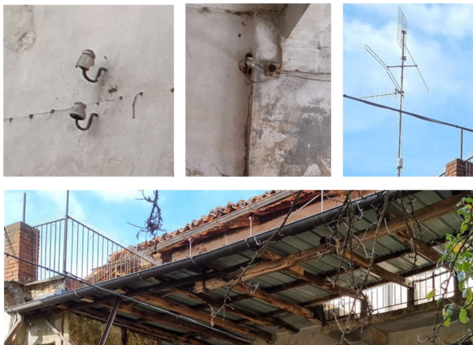
Figura 37: Dall'alto a sinistra, elementi di vecchi impianti della distribuzione elettrica; impianto interno obsoleto; ricevente segnale analogico tv; tettoia in lamiera di cui si prevede la rimozione.
