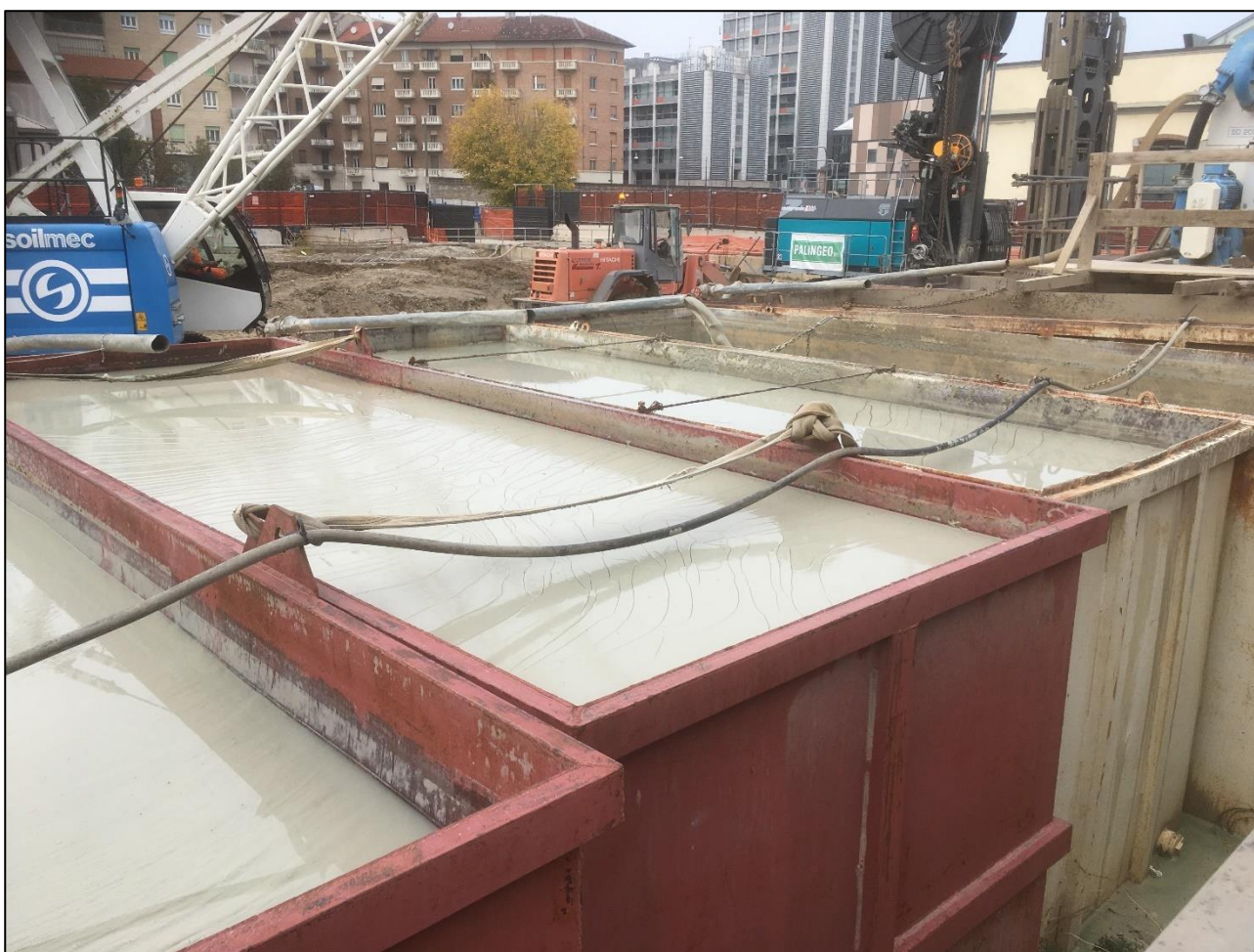
Figura 6.4: dettaglio del contenuto di alcune vasche
