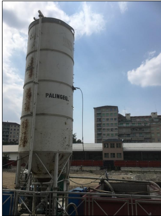
Figura 16.11: silo contenente la bentonite
