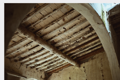
Ambiente 1.08 | Presenza di infiltrazioni dal lucernario che hanno portato alla lesione dell'arco in chiave. I travetti inoltre sono leggermente inflessi, alcuni spezzati e vi è la presenza in cordolo in c.a.
