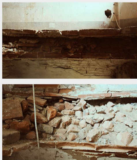
Ambiente 0.12 | "Sezione" longitudinale della volta in foglio parzialmente crollata. In alto: porzione centrale. In basso: porzione vicina ai muri laterali.
