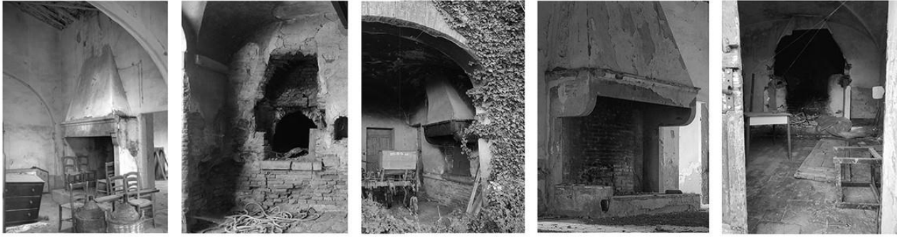
Figura 12 Forni e Focolari di alcune Leopoldine studiate durante i sopralluoghi in Valdichiana. I primi due a sx appartengono al Podere Primo di Brolio.
