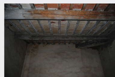
Ambiente 1.06 | Travetti non connessi all'arcareccio che si collega al paradosso angolare sulla muratura in cui è presente in il cordolo in c.a.
