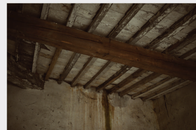
Ambiente 1.11 | Presenza di infiltrazioni importanti nella porzione in cui i travetti, leggermente inflessi, si appoggiano ai muri interni.
