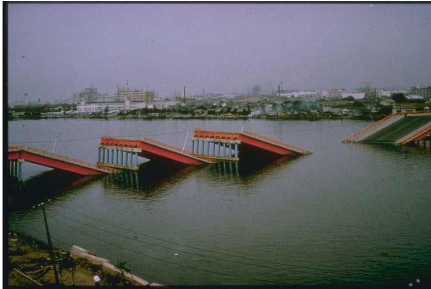
Figura 6: Showa Bridge, Niigata, 1964, terremoto di magnitudo 7.5
