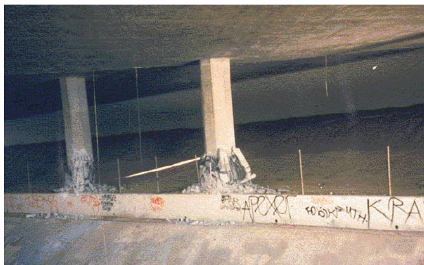
Figura 4: Creek Canyon Channel Bridge, Terremoto di Northridge del 1994
