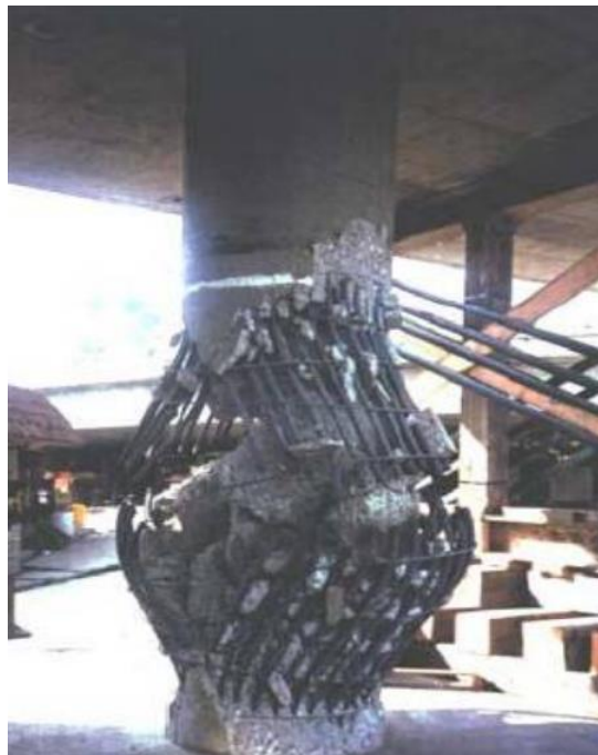
Figura 9: Instabilità delle barre longitudinali per mancato confinamento
