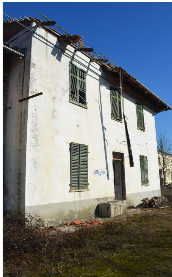
| La seconda abitazione con danni alla copertura.
