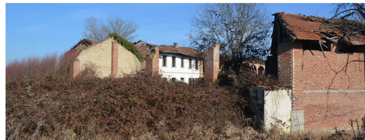
| I pilastri ed il muro della parte di tettoia priva di copertura.
