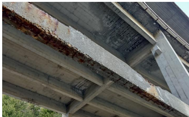
Figura 3.4- Fenomeno di espulsione del copriferro e ossidazione delle armature
