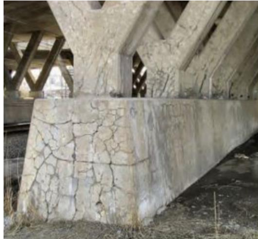
Figura 3.2- Esempio di degrado per reazione alcali-silice, Meka Global
