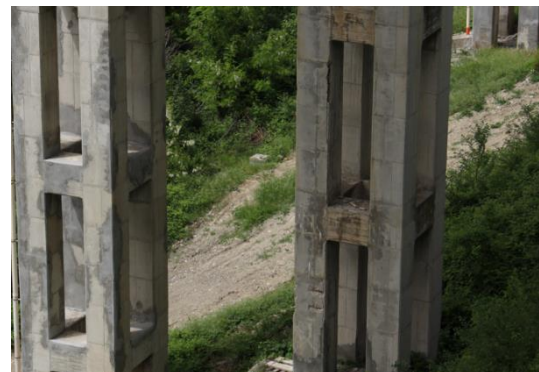
Figura 7.37- Opera d'arte M2: condizione di ammaloramento delle pile, con presenza di fessure trasversali
