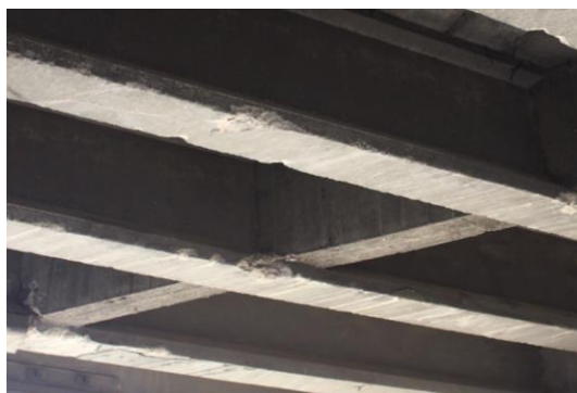
Figura 7.38- Opera d'arte R1: danni da urto, con conseguente esposizione armature, nelle travi prefabbricate
