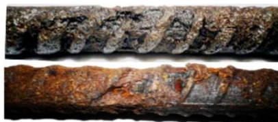
Figura 3.6- Riduzione di sezione delle barre di armatura dovuta ad attacco clorurico
