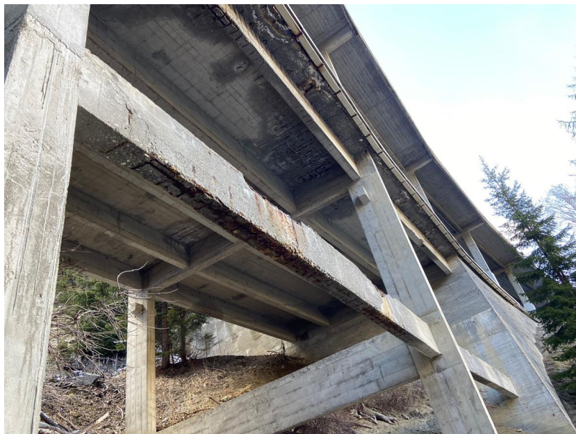
Figura 7.1 – Particolare di un viadotto ammalorato appartenente all'infrastruttura analizzata
