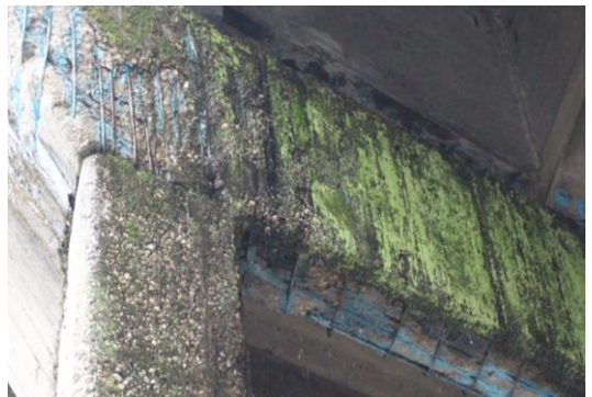
Figura 7.39- Opera d'arte R2: elevato avanzamento di degrado per inefficienza del sistema di drenaggio
