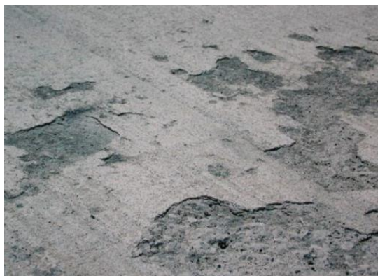
Figura 4.2- Esempio di ammaloramento superficiale del calcestruzzo
