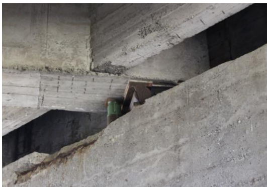
Figura 7.36- Opera d'arte M1: dilavamento del calcestruzzo con esposizione di armature, e presenza di vespai
