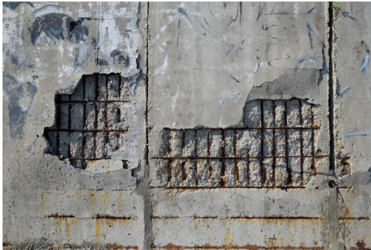
Figura 1: Blocco di cemento armato che a causa della degradazione espone le armature ad attacchi chimici causando formazione di ruggine
