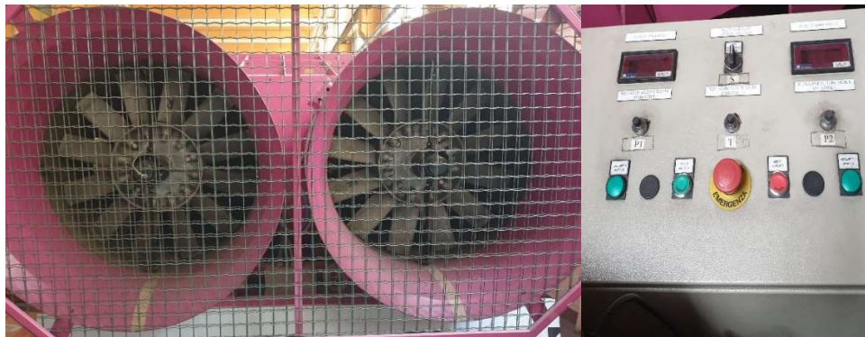
Figura 2.6: a) ventole della galleria; b) pannello di controllo
