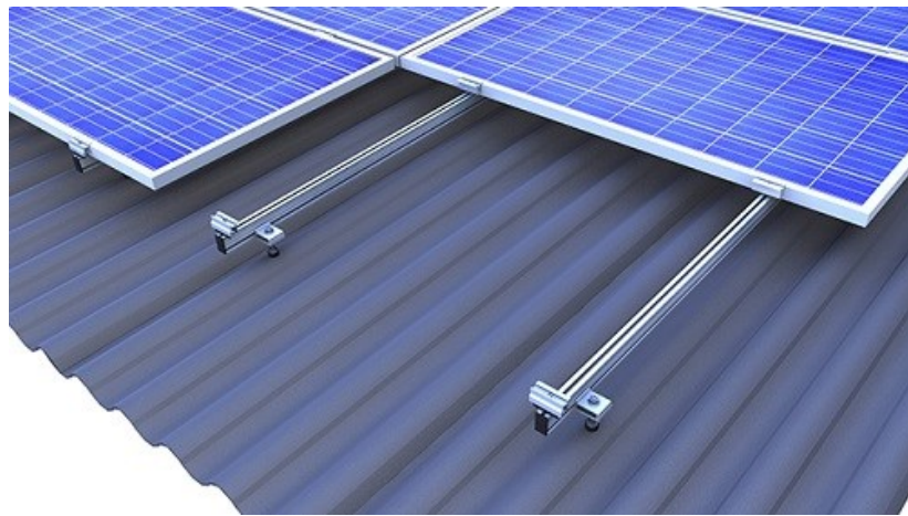
Figura 4-11- Esempio di impianto FV disposto su lamiera- Fonte: https://www.infobuildenergia.it/
