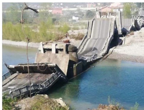
Figura 2.13: Crollo del ponte di Albiano Magra [12]
