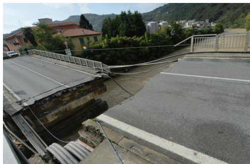
Figura 2.3: Crollo del ponte sul torrente Sturia [12]
