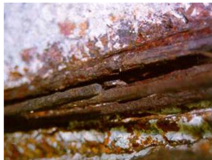
Figura 3.2: Visione ravvicinata di cavi da pretensione corrosi [20].
