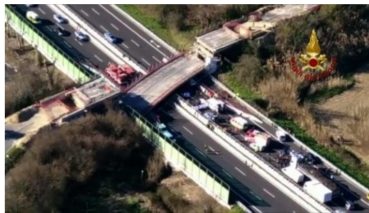
Figura 2.9: Crollo del cavalcavia sulla A14 all'altezza di Camerino [12]
