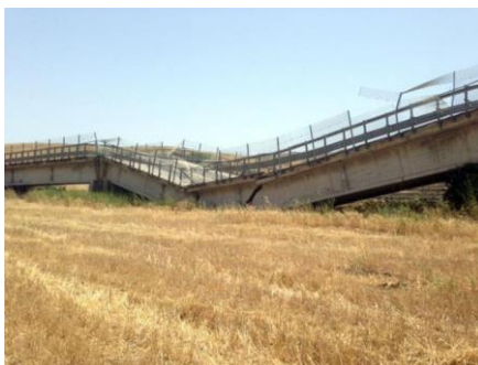
Figura 2.5: Crollo del ponte sulla statale 626 tra Ravanusa e Licata
