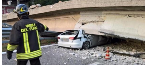
Figura 2.8: Crollo del cavalcavia sulla statale Milano – Lecco [12]
