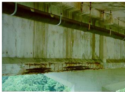
Figura 3.1: Esempio di fenomeni di degrado in un graticcio [20].
