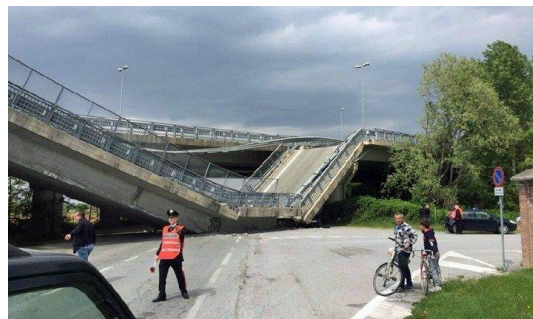
Figura 2.10: Crollo del cavalcavia sulla tangenziale di Fossano [12]
