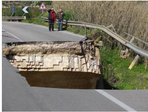
Figura 2.2: Crollo del viadotto Verdura nel 2013 [11]
