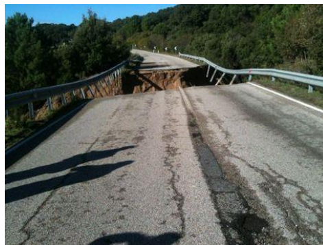
Figura 2.4: Crollo del ponte sulla provinciale 38
