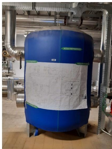
Figura 4.5 Accumulo acqua refrigerata
