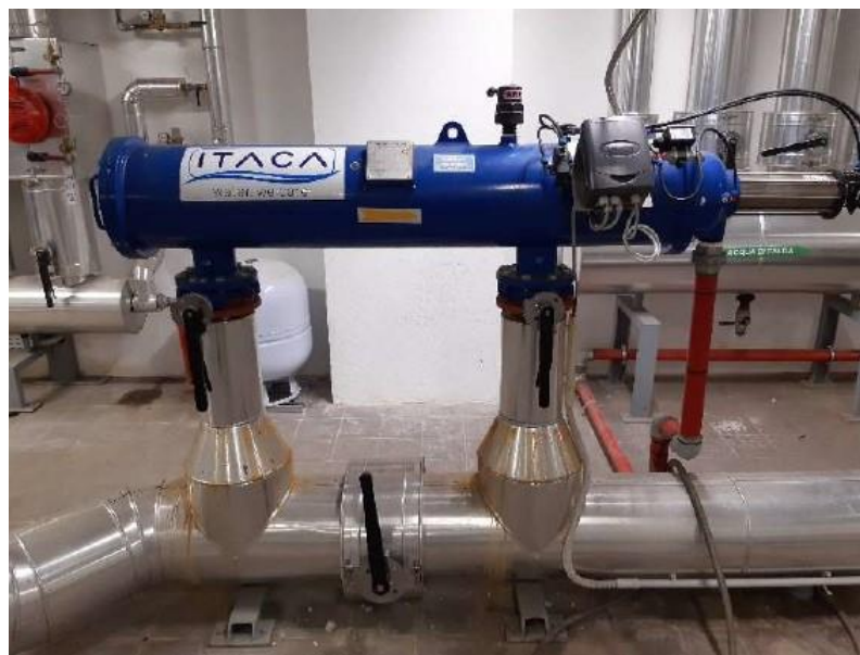
Figura 4.6 Tubazione acqua di falda con filtro
