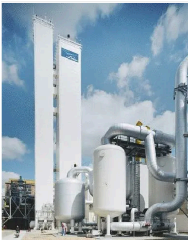
Fig. 2.4 immagine di un impianto con serbatoi
