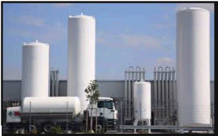
Fig. 1.8 impianto criogenico a 4 serbatoi
