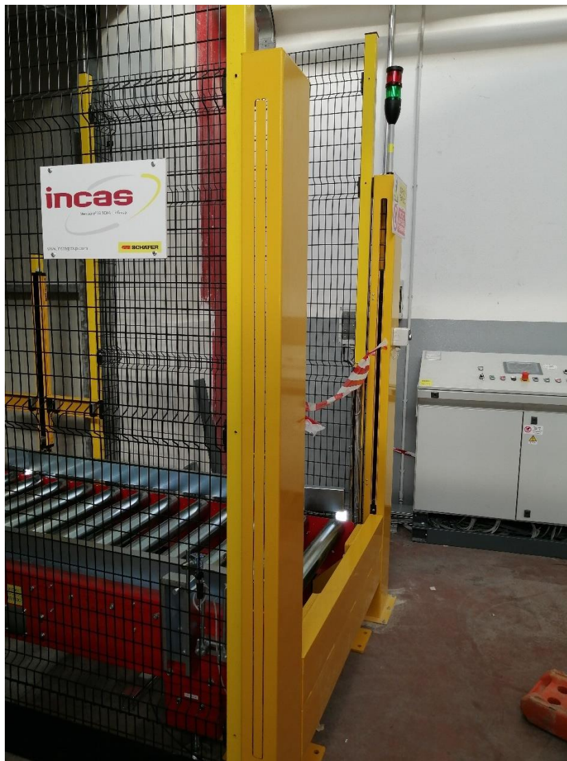
Figura 5. 94 - Dettaglio barriera di emergenza su DRC1
