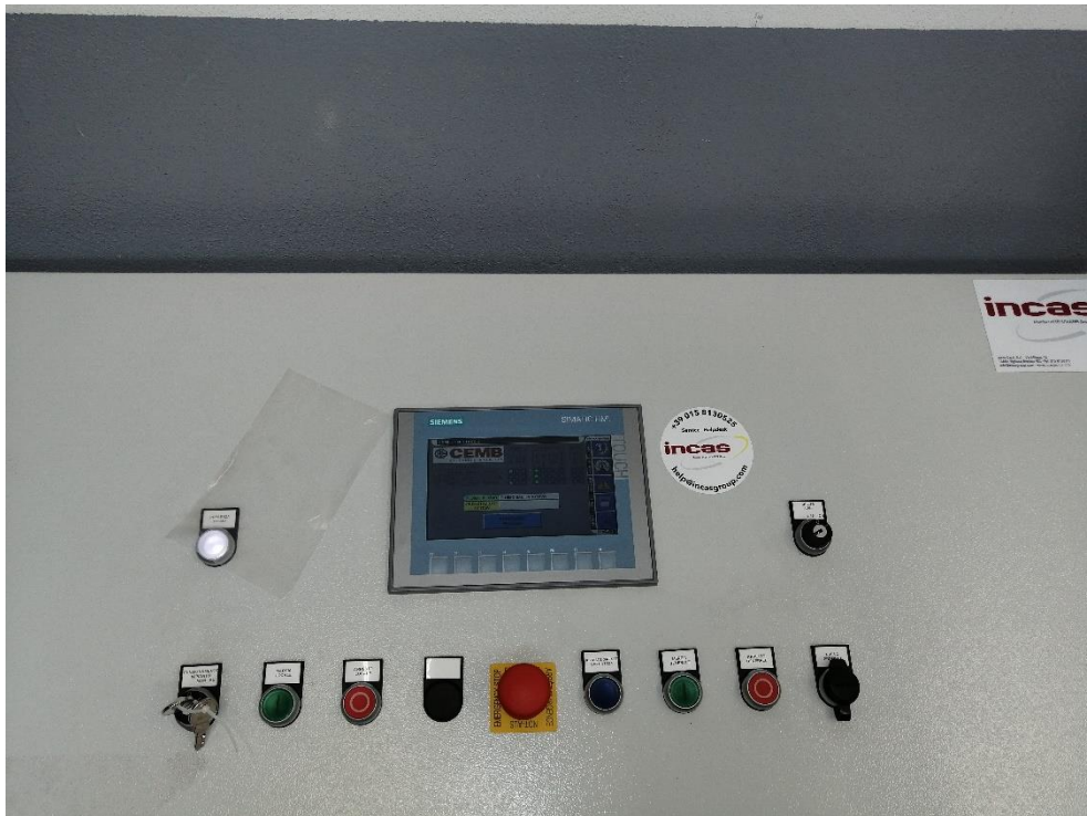
Figura 5. 93 - Dettaglio fronte quadro elettrico 19016
