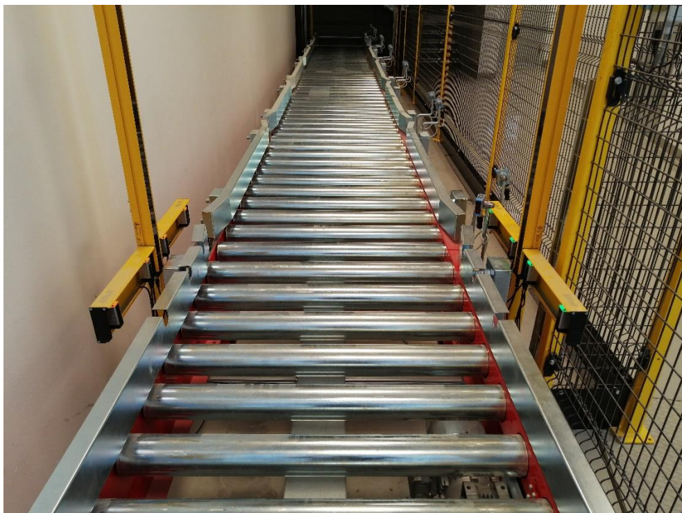
Figura 5. 92 - Dettaglio ingresso pallet al piano terra con barriera di muting
