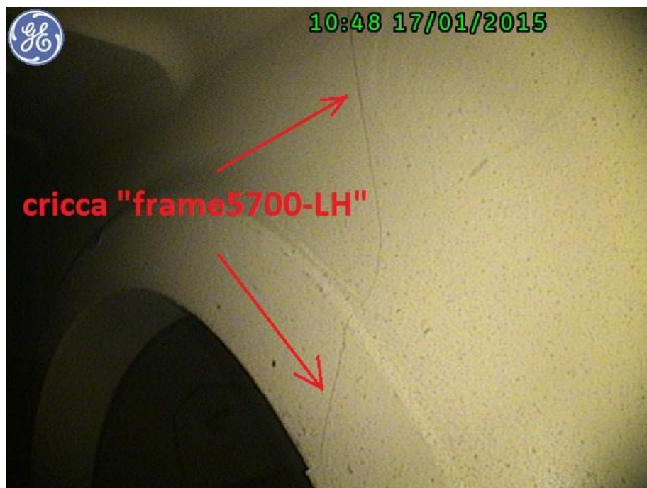
Figura 37: Estensione della cricca sul lato sinistro dell'ordinata a partire dal foro di alleggerimento
