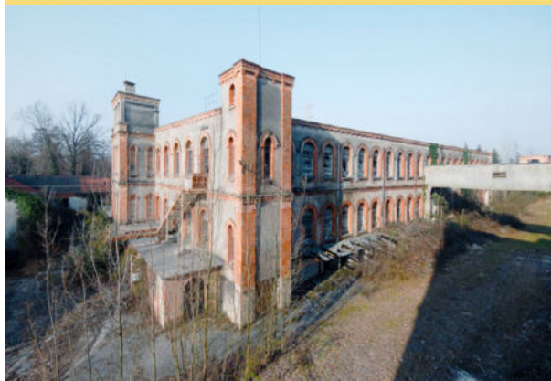
Il Cottonificio Makò oggi, in stato di abbandono. 5
