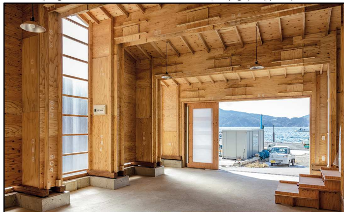
Fig.163 - Avanzamento lavori e fasi di cantiere del progetto Veneer House di Maeamihama, Miyagi (Giappone) 2013 -
