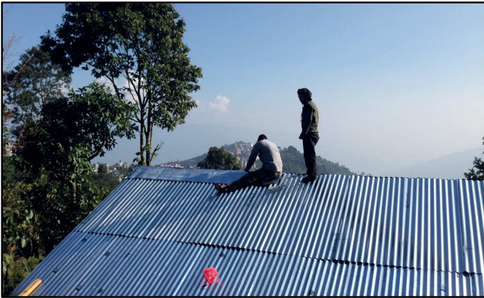
Fig.170 - Avanzamento lavori e fasi di cantiere del progetto Charikot Veneer House, Dolakha (Nepal) 2015 -
