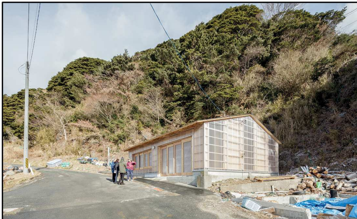
Fig.160 - Avanzamento lavori e fasi di cantiere del progetto Veneer House di Maeamihama, Miyagi (Giappone) 2013 -
