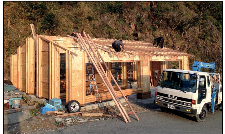
Fig.155 - Avanzamento lavori e fasi di cantiere del progetto Veneer House di Maeamihama, Miyagi (Giappone) 2013 -
