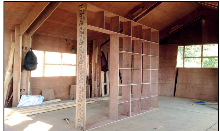
Fig.169 - Avanzamento lavori e fasi di cantiere del progetto Charikot Veneer House, Dolakha (Nepal) 2015 -
