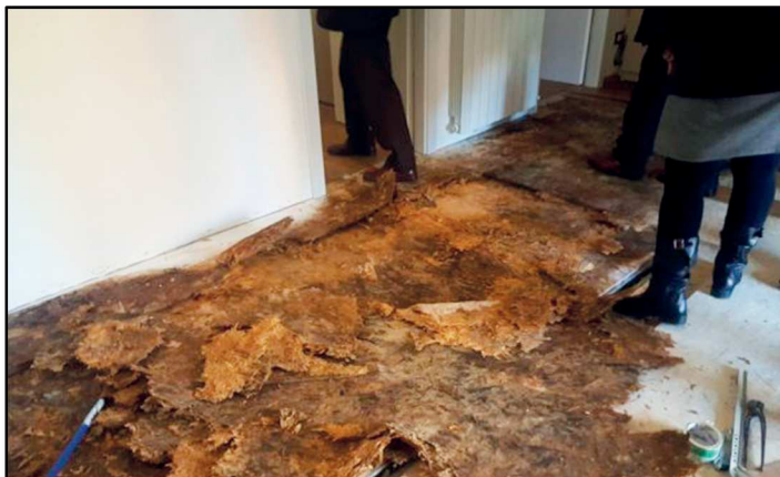
Fig.130 - Pavimento divorato dalla muffa in una S.A.E. di Muccia -
