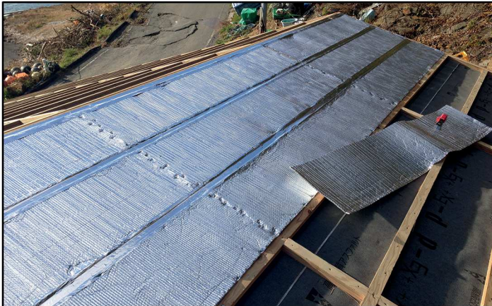
Fig.156 - Avanzamento lavori e fasi di cantiere del progetto Veneer House di Maeamihama, Miyagi (Giappone) 2013 -
