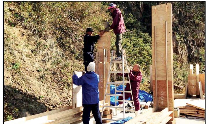
Fig.153 - Avanzamento lavori e fasi di cantiere del progetto Veneer House Maeamihama, Miyagi (Giappone) 2013 -
