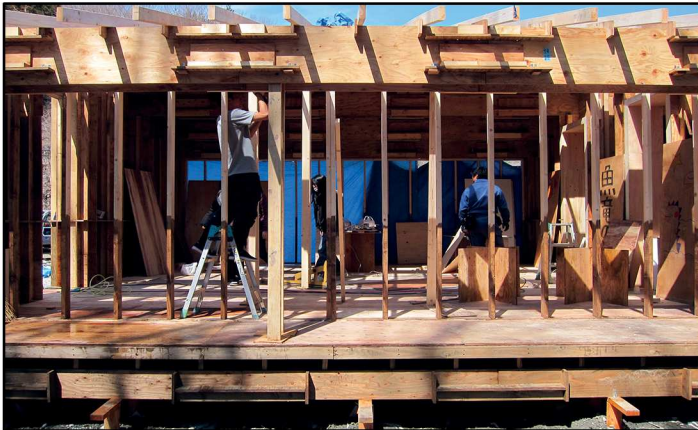
Fig.145 - Avanzamento lavori e fasi di cantiere del progetto Veneer House di Minamisanriku, Miyagi (Giappone) 2012 -
