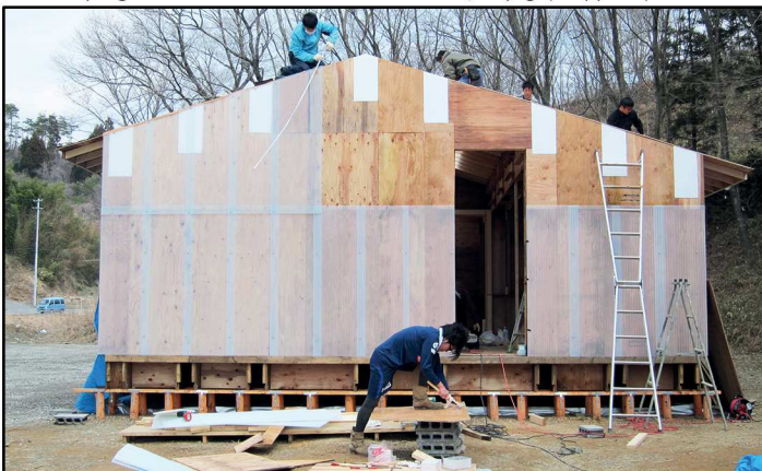
Fig.149 - Avanzamento lavori e fasi di cantiere del progetto Veneer House di Minamisanriku, Miyagi (Giappone) 2012 -
