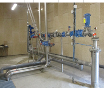
Photos du captage et des différents équipements
