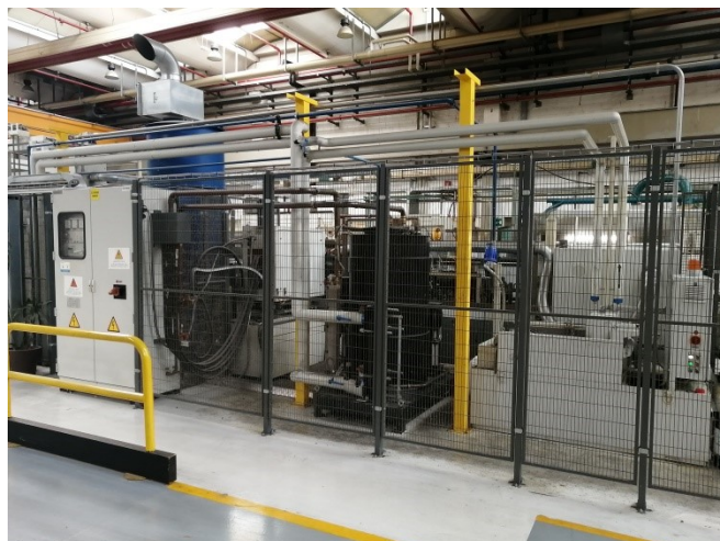
Figura 5.25 : panoramica degli impianti ausiliari della macchina
