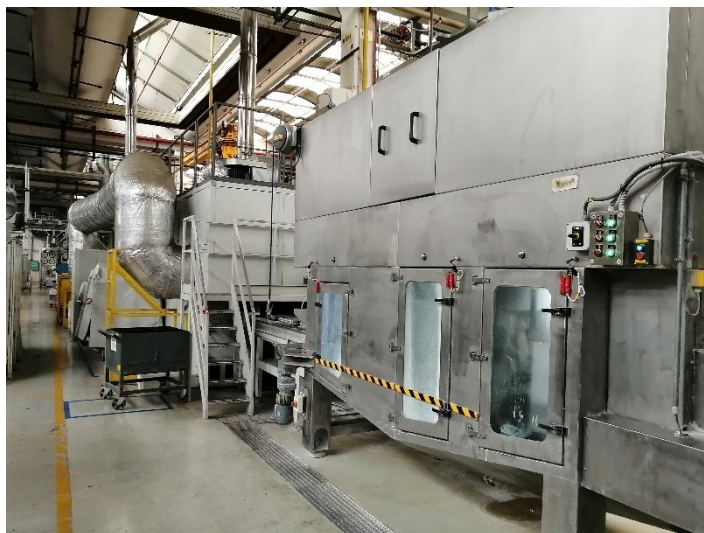
Figura 2.12 : porzione di uno dei forni di brasatura presenti in stabilimento
