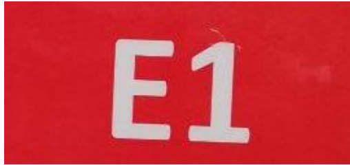
Figura 2.6. - Esempio di targhetta che indica un sezionamento elettrico per un interruttore principale
