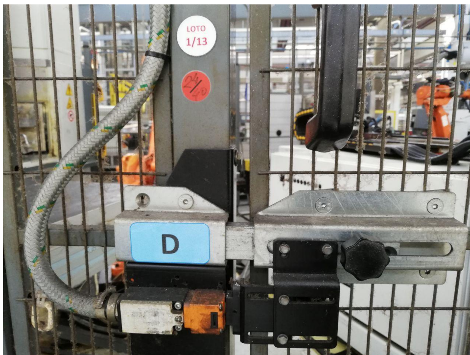
Figura 2.22. - Segnalazione porta di accesso alla zona di lavoro di una ITA.
