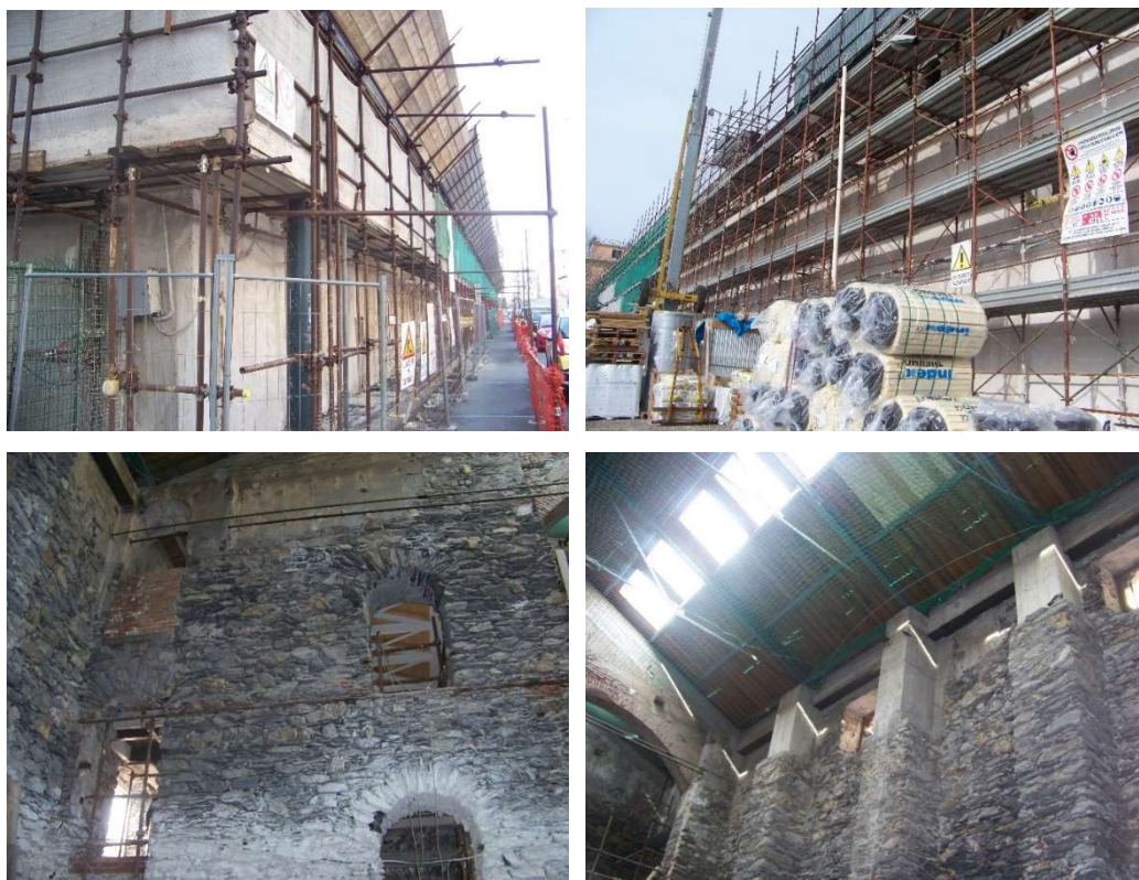
Immagini 31, 32, 33, 34 – Cantiere Ex Magazzini del sale, foto scattate durante sopralluogo in data 21/02/2020
