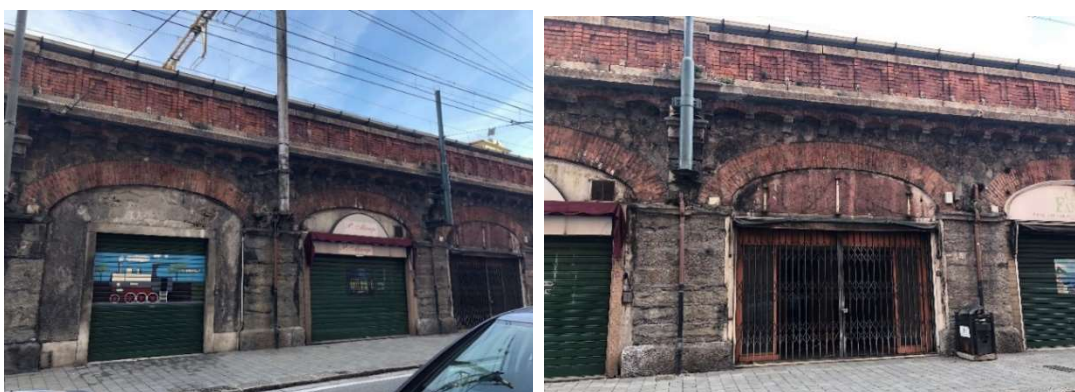
Immagini 48,49 - Voltini in stato di abbandono in via Buranello, foto scattate durante sopralluogo in data 21.02.2020
